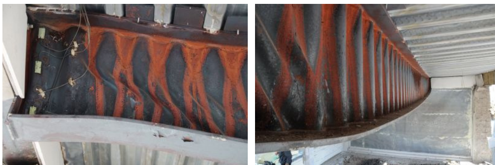
Figura 2.17: Vigas de alma senoidal após o fim do ensaio (Wald & Kallerová, 2009).
