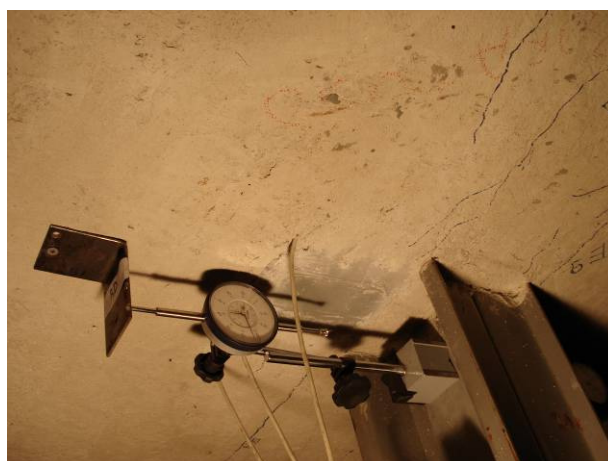
FIGURA 3.26 – Relógio comparador RC para medição da deformação do concreto (extensômetro mecânico).
