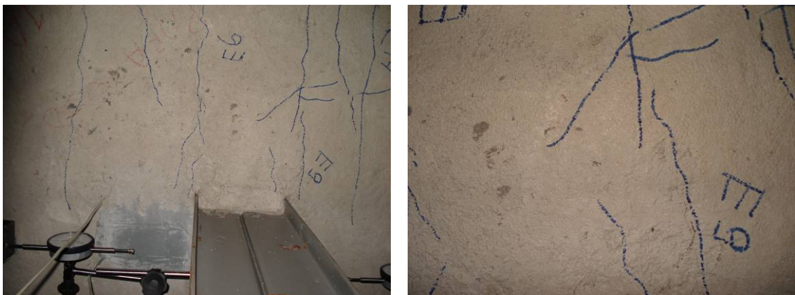
FIG. 4.32 - Fissuração presente no modelo 2A – face superior.
