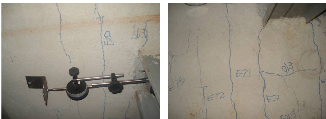
FIGURA 4.41 - Fissuração da face superior do modelo 4A.
