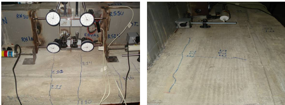
FIGURA 4.44 - Fissuração da face inferior do modelo 1BE.
