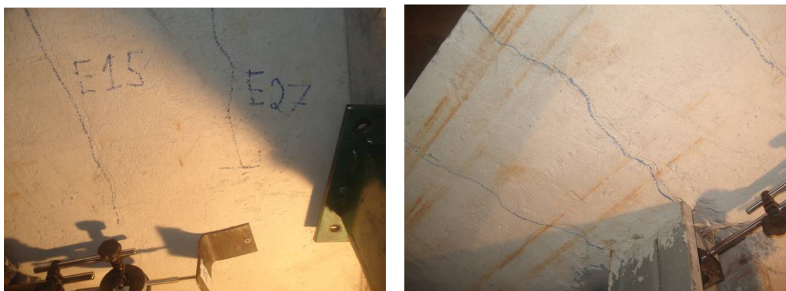
FIG. 4.29 – Fissuração face superior no modelo 1A.
