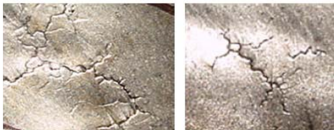
Figura 3.31 – Aspecto de uma trinca estrela na superfície da placa (OLIVEIRA, 2005).
