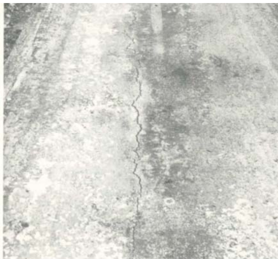
Figura 3.26 – Aspecto de uma trinca longitudinal facial na superfície da placa (AISE STEEL FOUNDATION, 2003).
