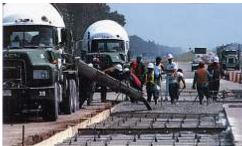
Figura 3.17 – Concreto elaborado com cimento geopolimérico, EUA, sendo lançado em pista de aeroporto.
