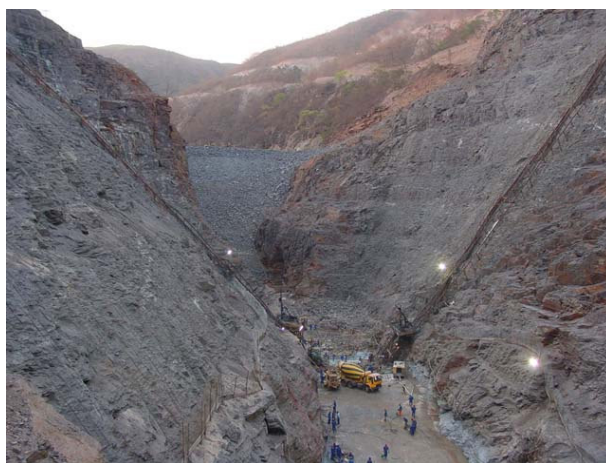
Figura 3.2 – Usina Hidrelétrica Irapé.
