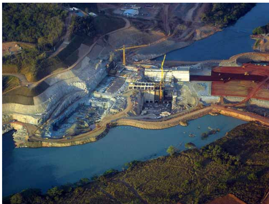
Figura 3.4 – Usina Hidrelétrica Capim Branco II.
