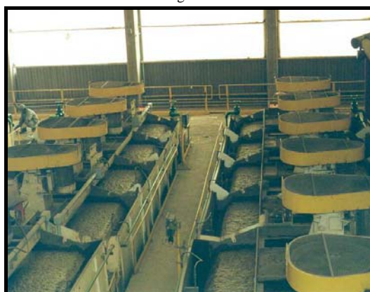
Foto 2.10 – Células de flotação scavenger do circuito de minério friável grosso.
