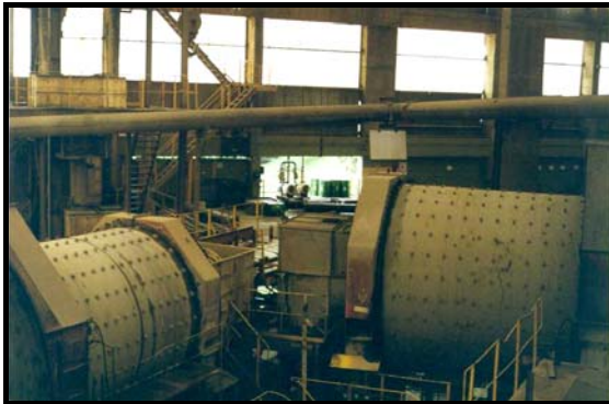
Foto 2.4 – Moinho de barras (esquerda) e moinho de bolas (direita) do circuito de minério granulado.
