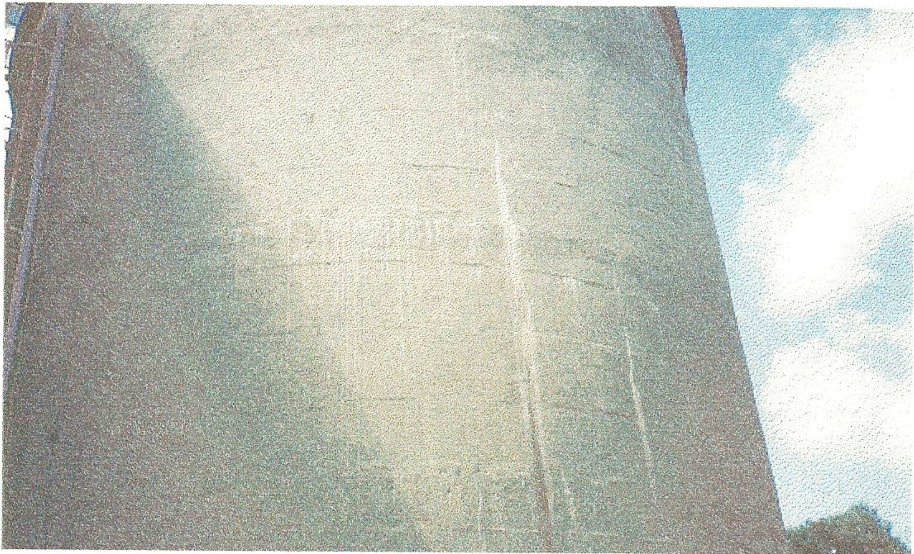
Figura 2.61 - Eflorescência de carbonato de cálcio em superfície de concreto, devido a percolação de água através de junta de concretagem.[24]
