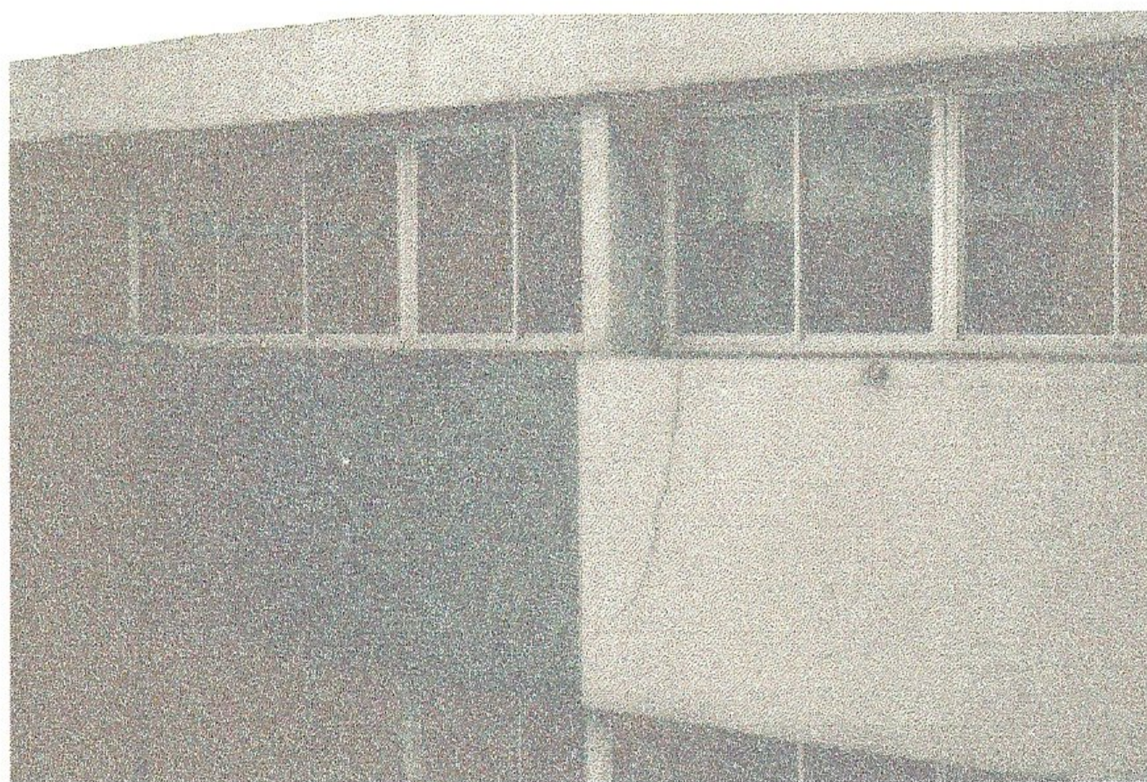
Figura 2.22 - Fissura de cisalhamento em viga alta. [22]
