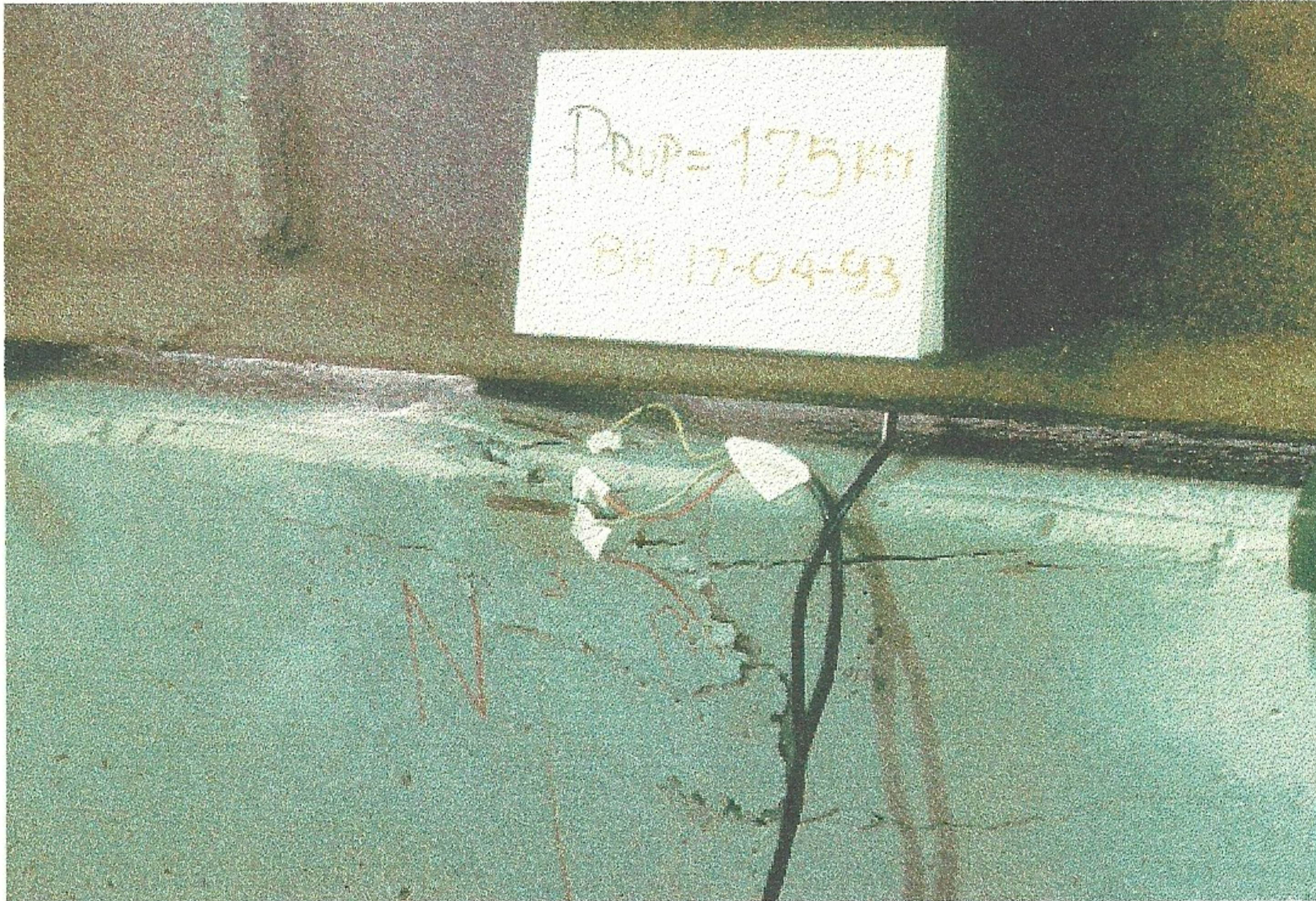
Figura 2.23 - Fissura devida ao esmagamento do concreto. [23]
