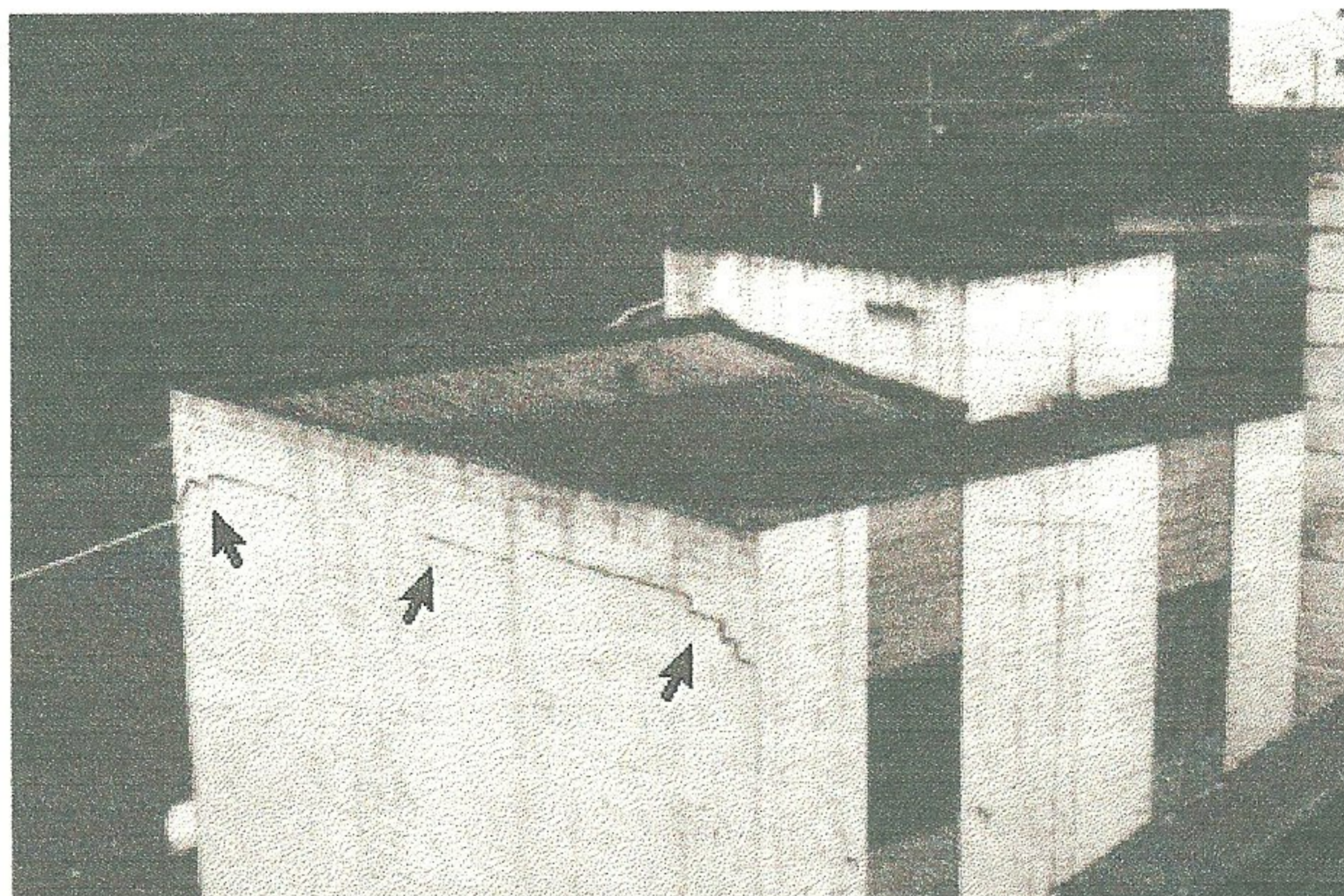
Figura 2.41 - Fissuras inclinadas no topo da parede ( em ambas as extremidades ) e destacamento da platibanda causados por movimentação térmica. [22]
