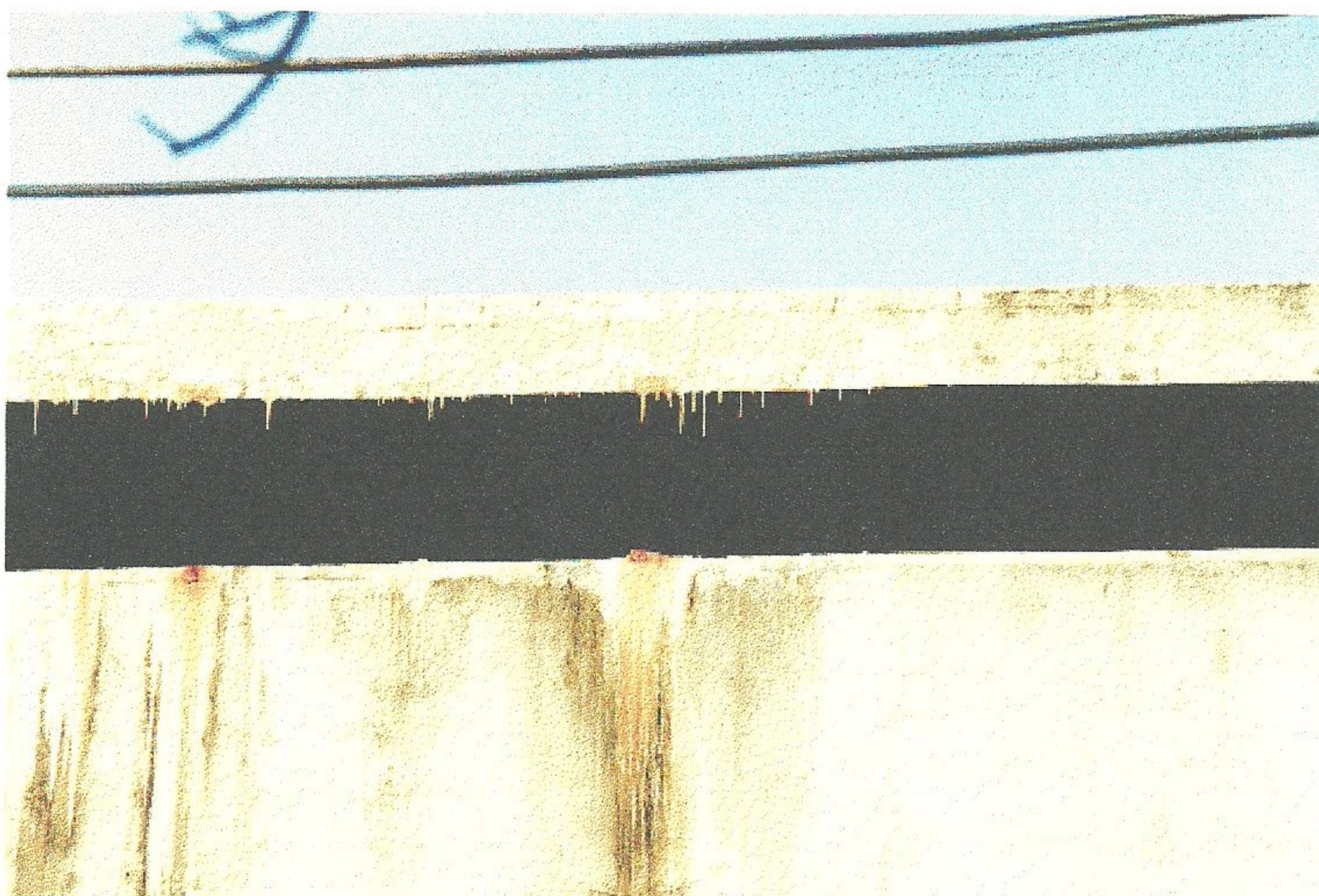
Figura 2.60 - Formação de estalactites devido à infiltração da água no concreto.
