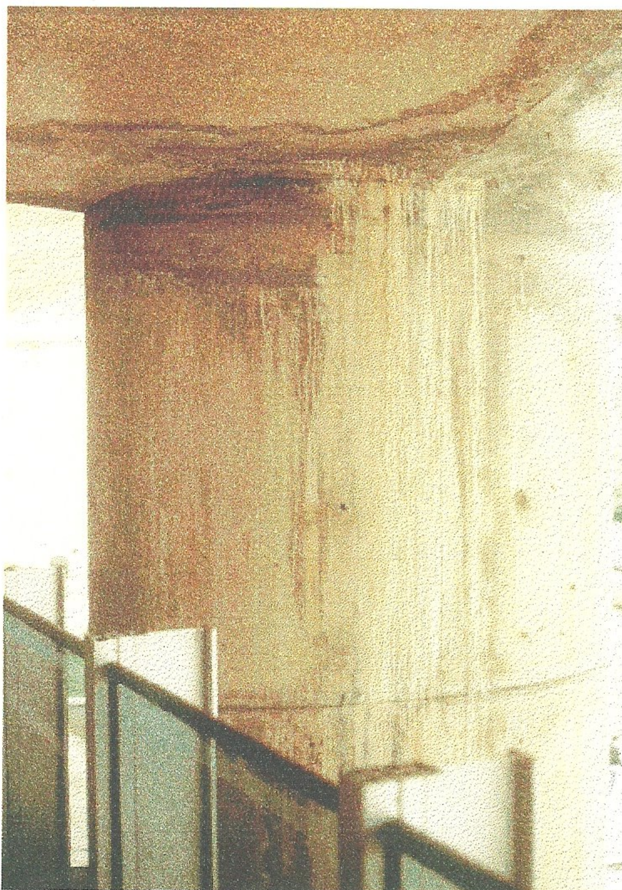
Figura 2.62 - Eflorescência de carbonato de cálcio de uma laje de cobertura.[23]
