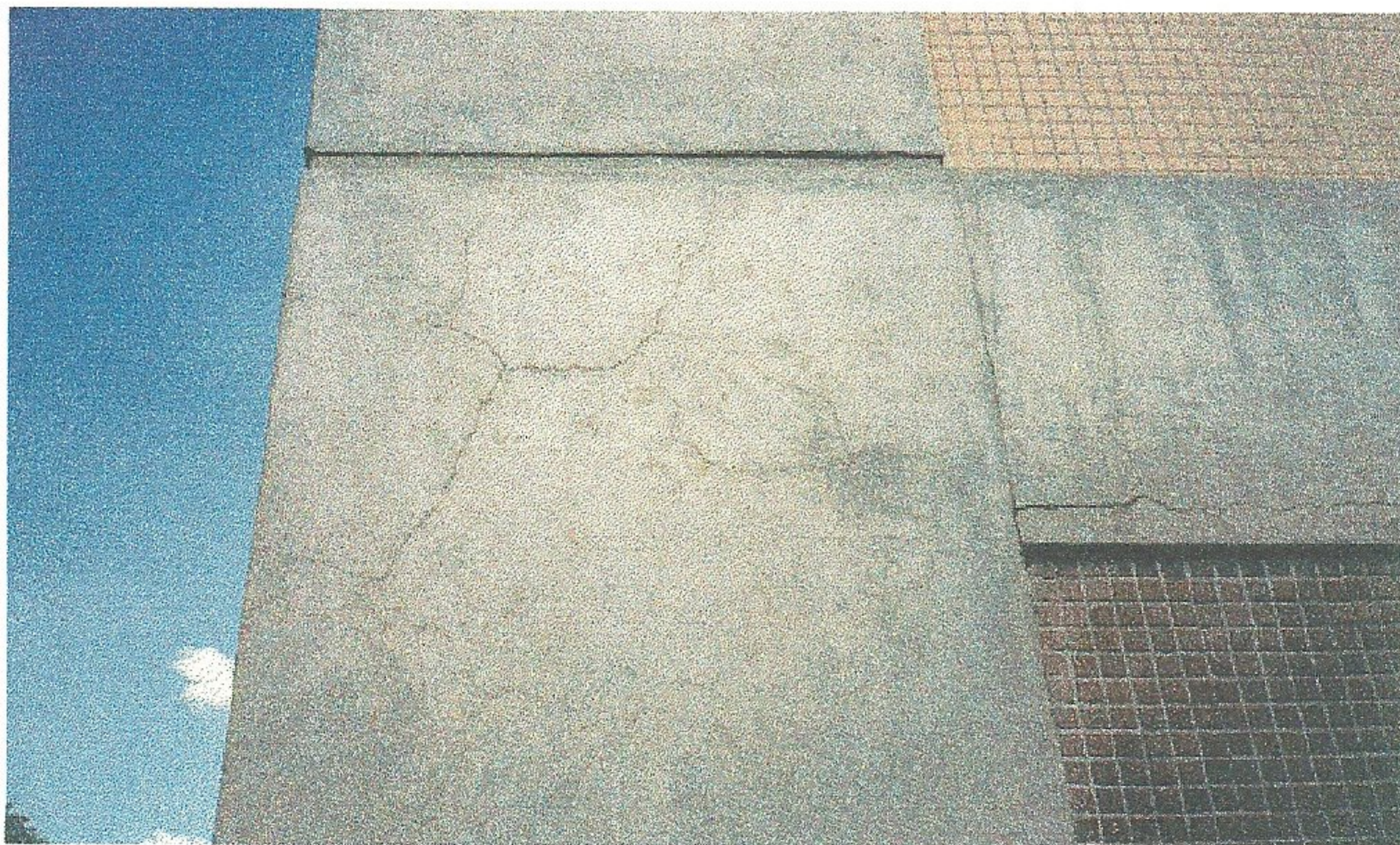
(c) Fissuras de retração num pilar de concreto armado. [24]
