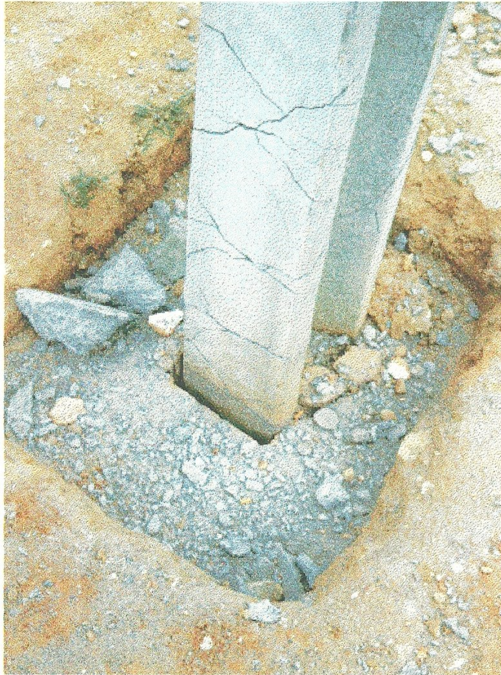
Figura 2.32 - Fissuras típicas em pilares de concreto armado devidas à rotação em torno do seu eixo. [23]
