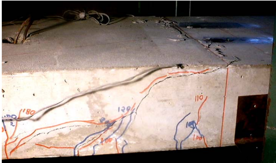
FOTO 5.5 – Detalhe da ruptura e do estágio final da fissuração
