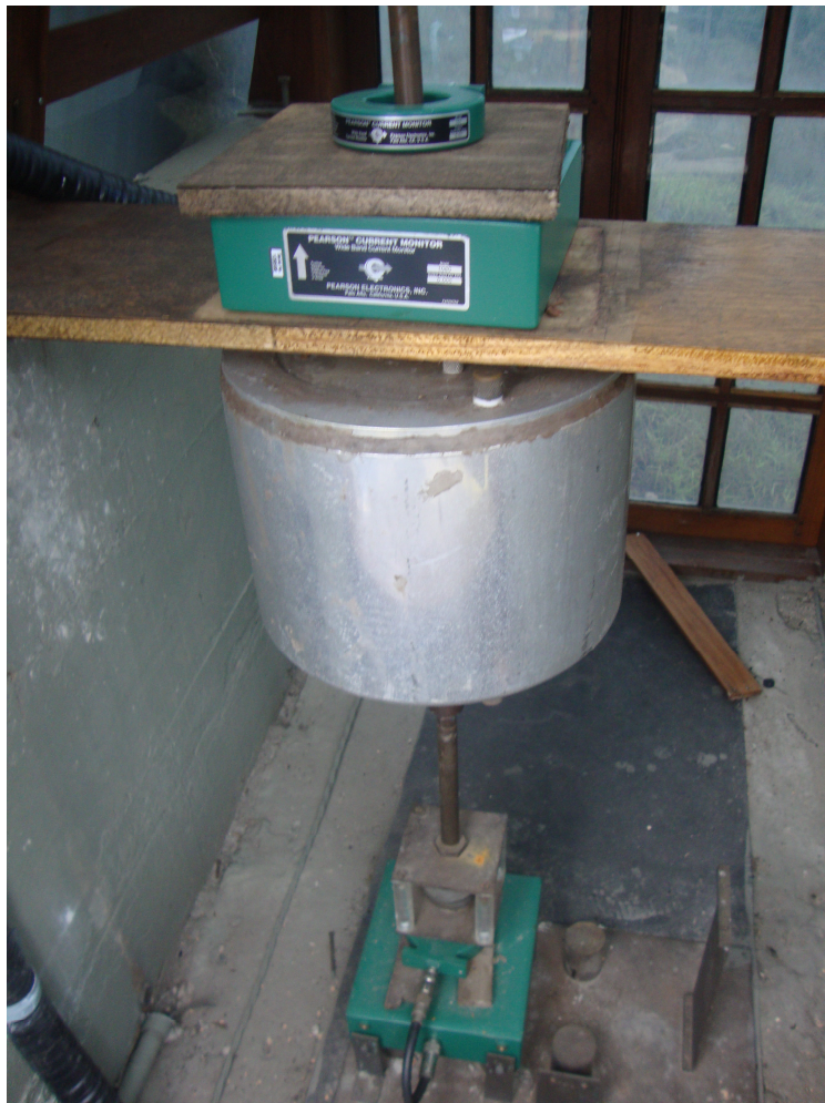
Fig. 3.15 – Bobinas de Pearson instaladas no abrigo. Nessa imagem também se vê outro par de bobinas e um resistor “Shunt” para medições redundantes de corrente.
