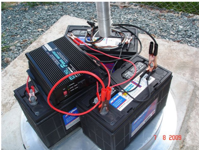
Fig. 3.9 – Baterias e inversor instalados no local.
