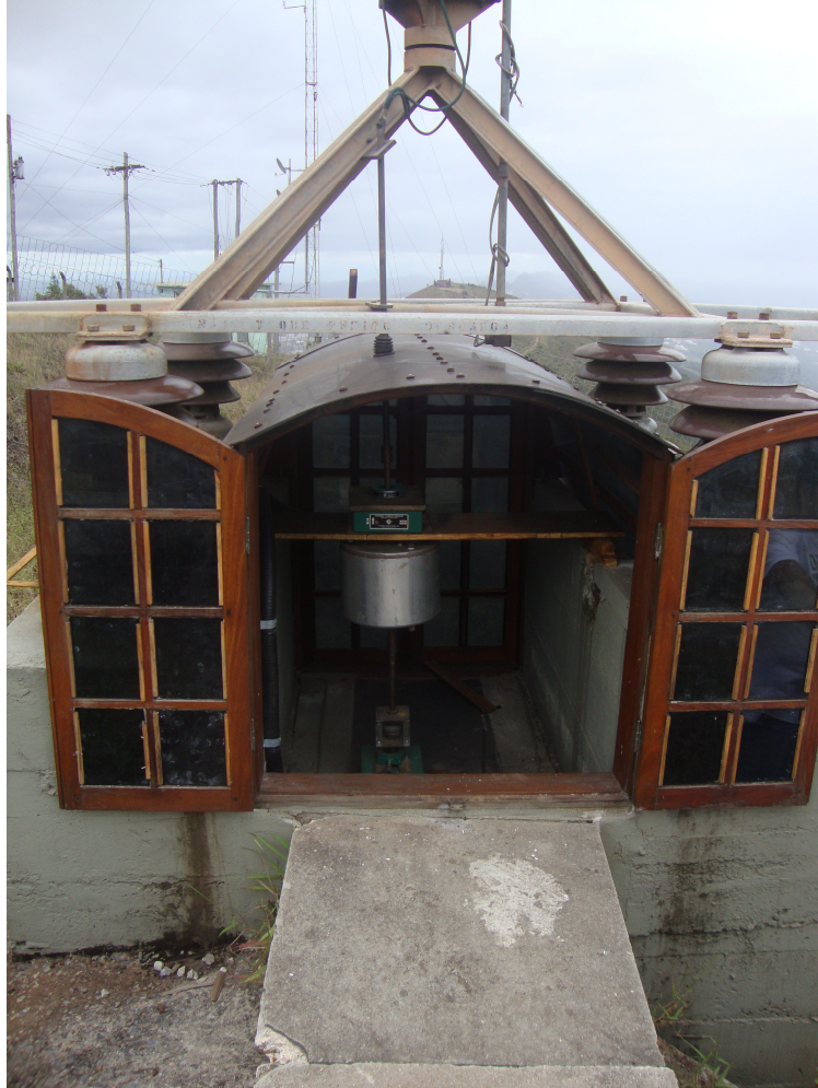
Fig. 3.13 – Abrigo na base da torre instrumentada da estação
