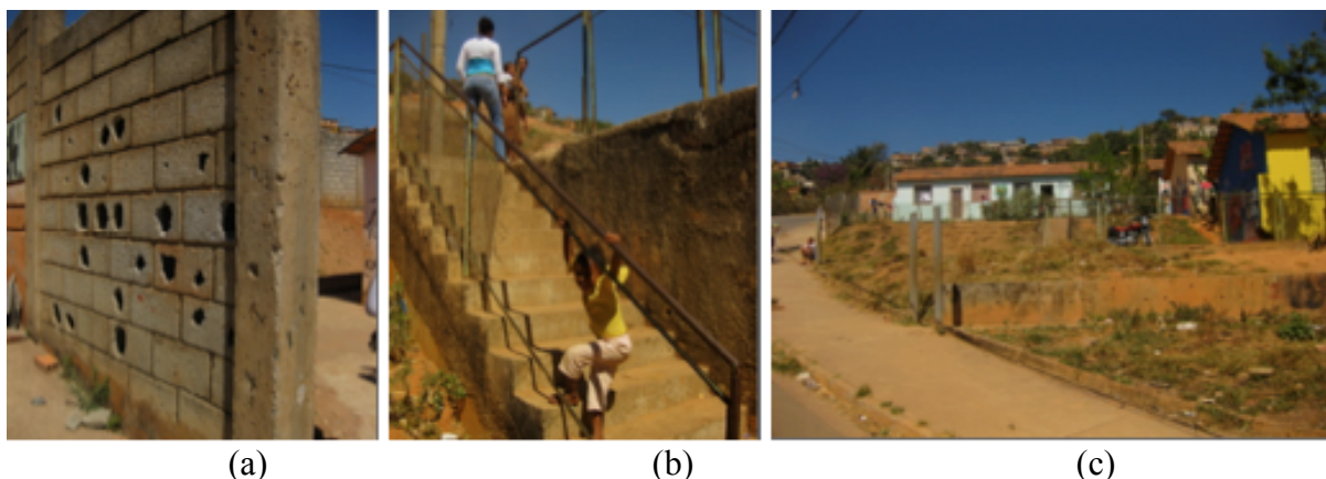
FIGURA 80 – Locais onde a cerca foi retirada e muros danificados Fonte: Autor, 2010
