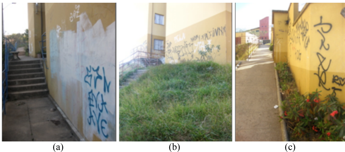
FIGURA 45 – Presença de pichações nos fundos e na frente dos blocos Fonte: Autor, 2010
