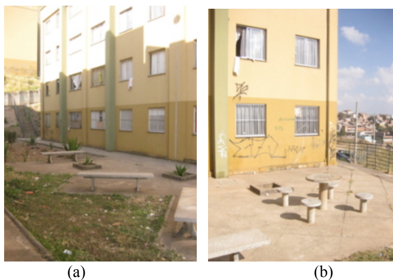
FIGURA 62 – Áreas de fundos entre os blocos 11, 12, 13 e 14 do GFII - Verdes Fonte: Autor, 2010
