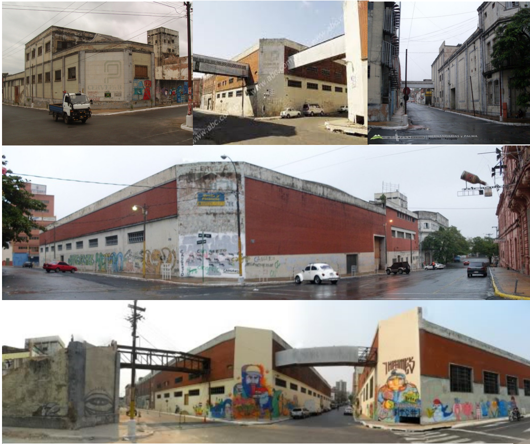
FIGURA 213 : Prédios da Ex- fábrica da Cervejaria Paraguaia, atualmente utilizados para eventos, levam o nome de “Casco Antigo”. Os mesmo se encontram muito deteriorado, e vem sendo demolidos lentamente pelos proprietários.
