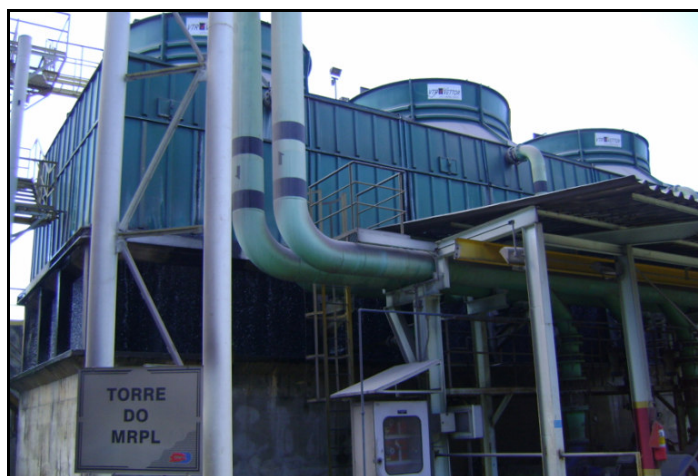
FIGURA 3.4 – Torre de resfriamento de água da chaminé do MRPL.
