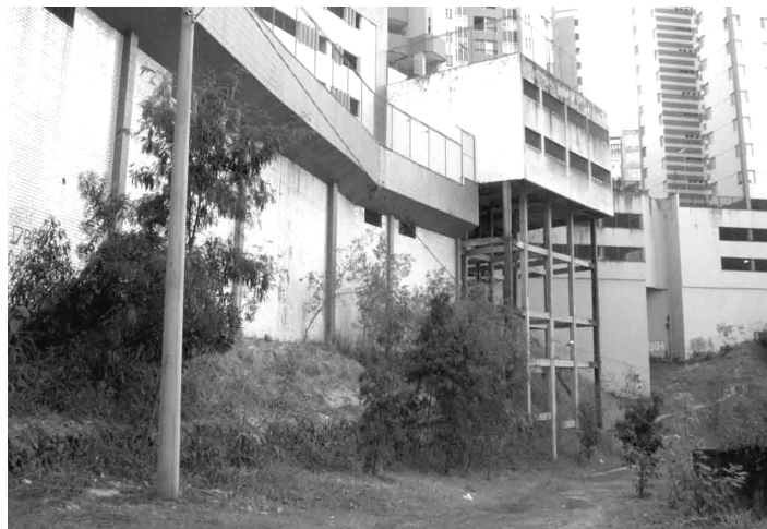
FIGURA 20 – A estrutura exposta de um dos prédios (palafitas) Fonte: Arquivo pessoal da autora, 2010
