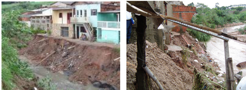
FIGURA 4.26 – Foto representando o talude de córrego (Fonte:Ministério das Cidades, 2007).
