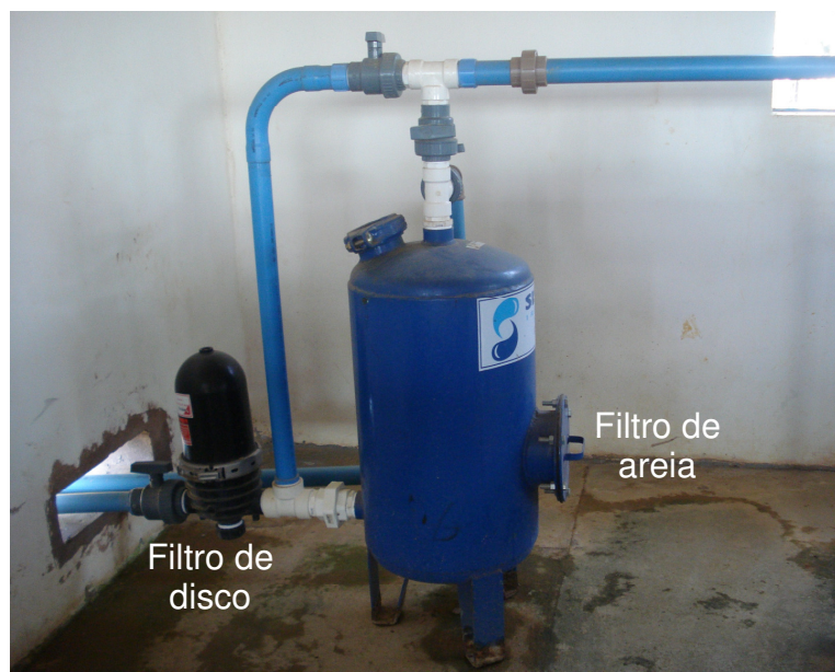
FIGURA 4.5 - Filtro de areia e filtro de disco do sistema de irrigação
