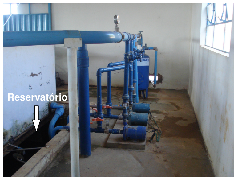
FIGURA 4.4 - Vista do bombeamento da água e sistema de filtros do sistema de irrigação
