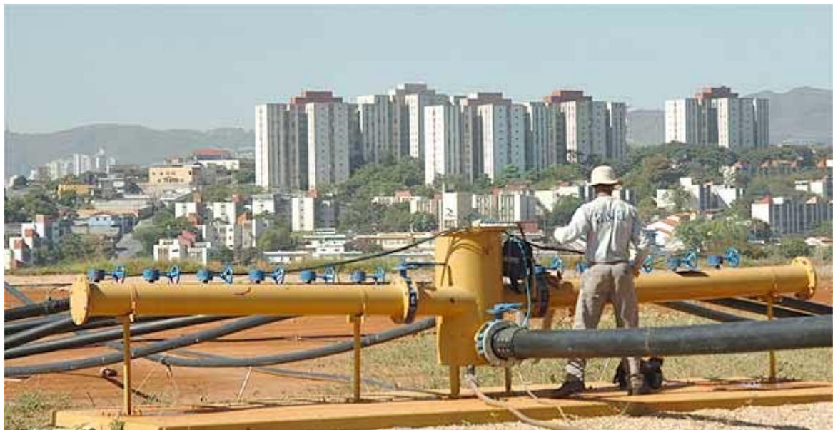
Figura 7 – Tubos que fazem a captação do biogás no aterro sanitário da BR040
