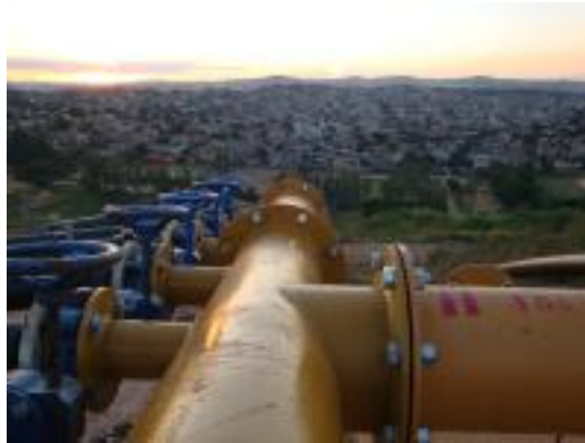
Figura 6 - Tubos que fazem a captação do biogás no aterro sanitário da BR040
