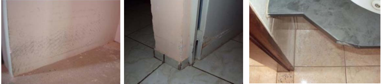
FOTO 26 e 27 - Paredes danificadas pelas batidas da cadeira de rodas.
