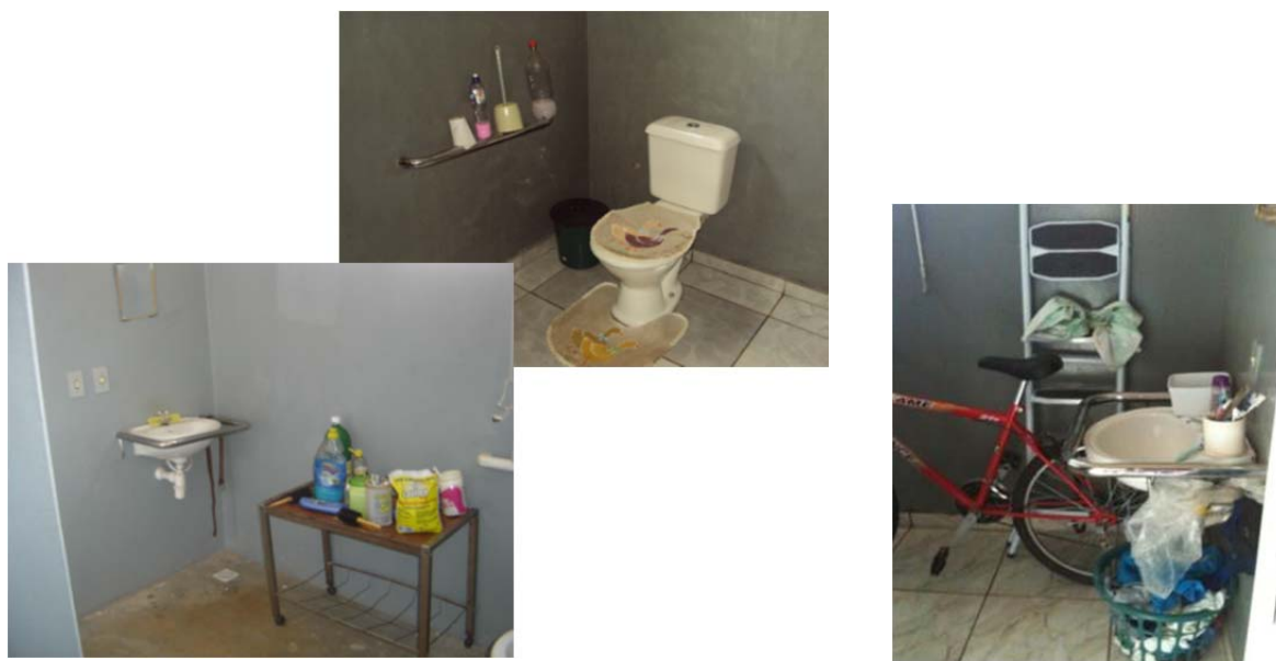
FOTO 50 e 51 – Falta de previsão de local para armazenamento de produtos.
