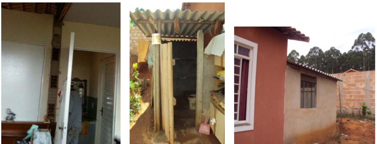
FOTO 29 - Abertura de vão devido à falta de espaço.
