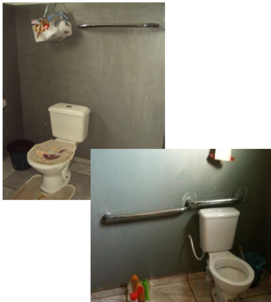
Fotos 36 e 37 - Erro de execução de obra impedindo o uso do espaço.
