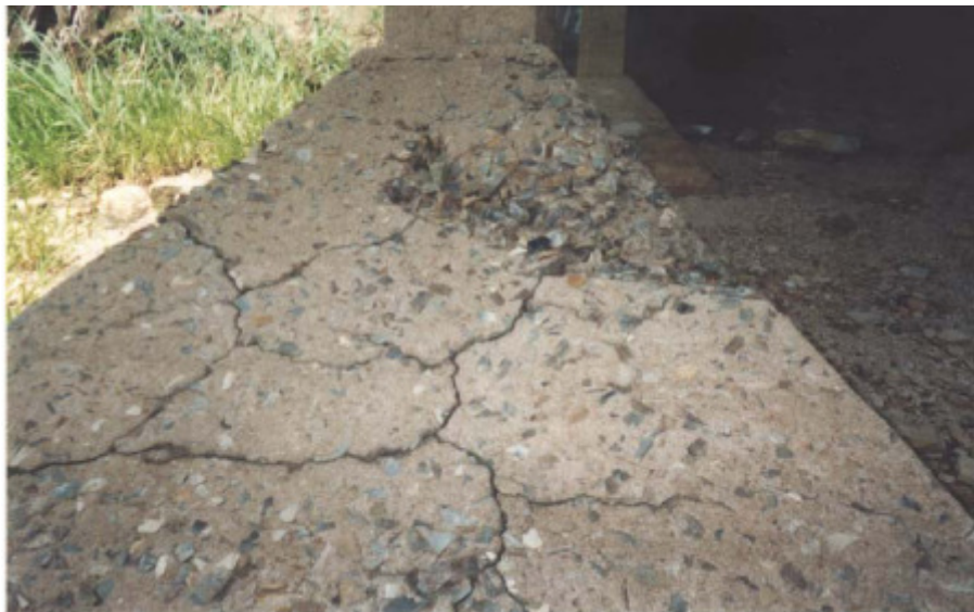
Figura 3-60 Trincas características de ocorrência de R.A.A (Pinheiro, 2003)
