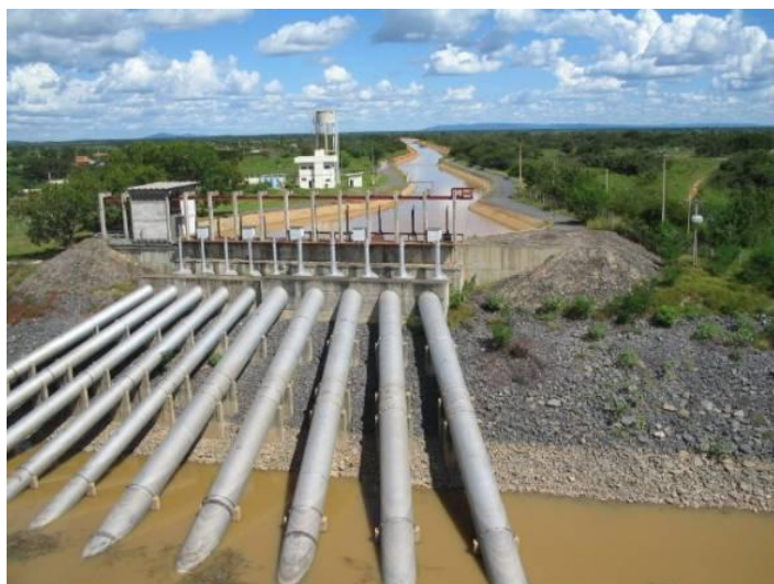
Figura 3-7 – Estação de bombeamento 1, captando água diretamente no rio São Francisco. Fonte: SILVA, 2006
