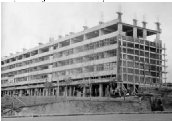
Figura 89 - Construção da Unidade Residencial I. Detalhe para a estrutura de pilares de apoio à quinta laje de cobertura, posteriormente demolida
