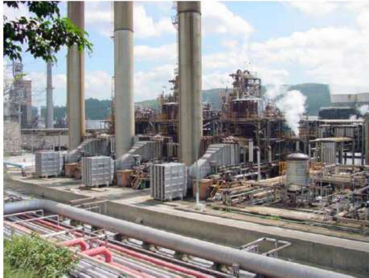
Figura 21- Fotografia das caldeiras da U-121 na REGAP.
