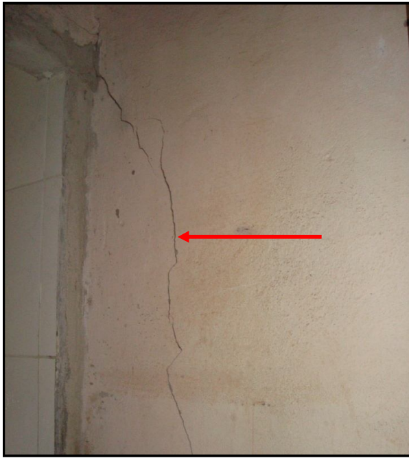
Figura 5.6 Presença de rachadura em parede
