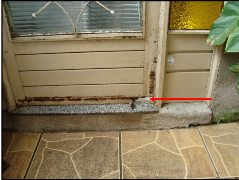
Figura 5.4 Porta metálica danificada na parte inferior (casa 16)
