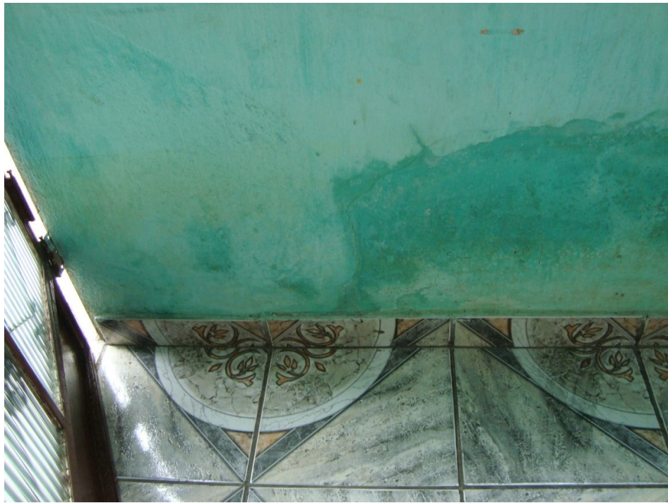
Fotografia 60 – Pintura danificada em parede da sala
