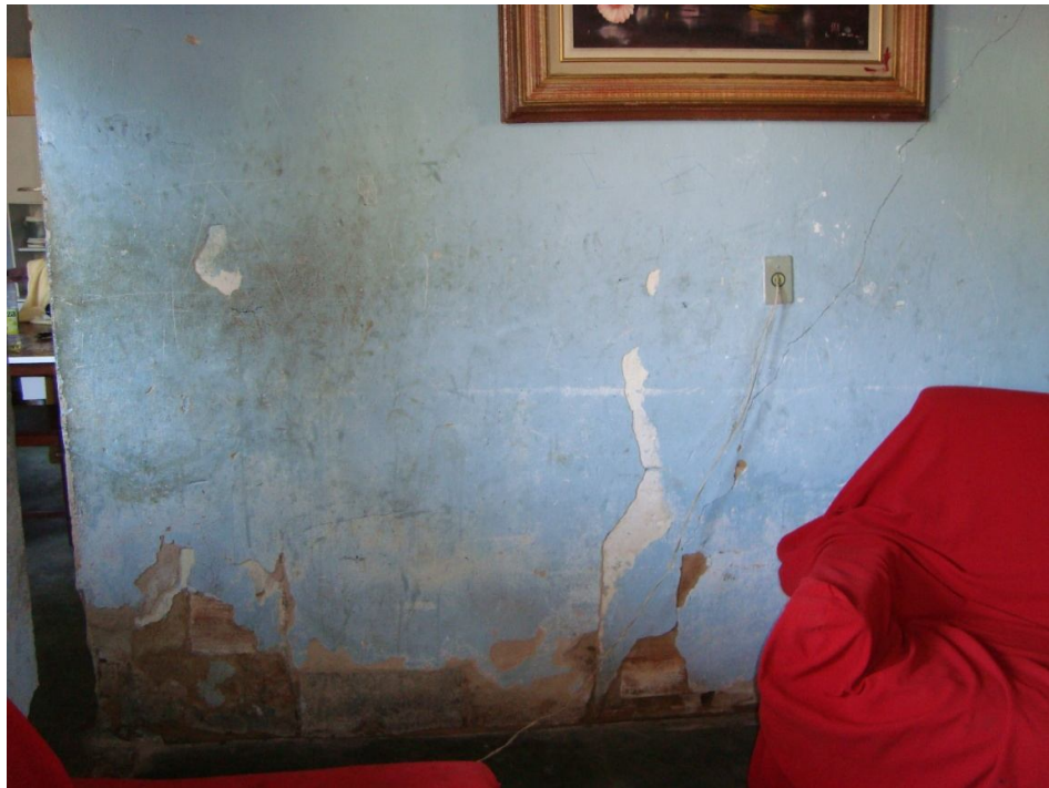
Fotografia 40 – Paredes internas danificadas
