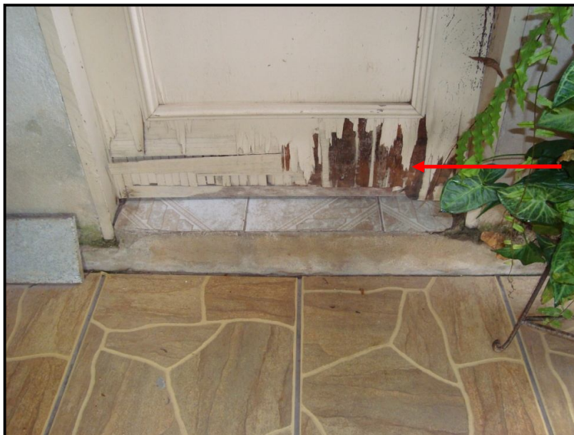
Figura 5.5 Porta de madeira danificada na parte inferior (casa 16)
