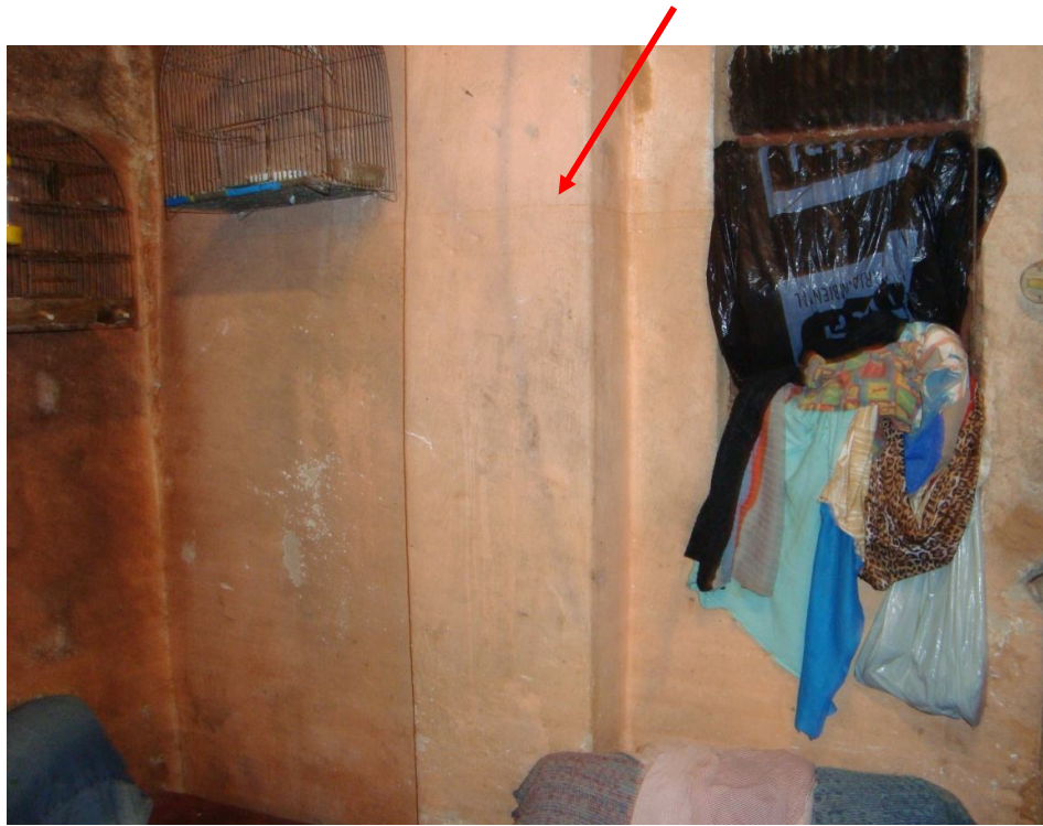
Fotografia 64 – Presença de manchas de umidade (marcas da inundação) nas paredes
