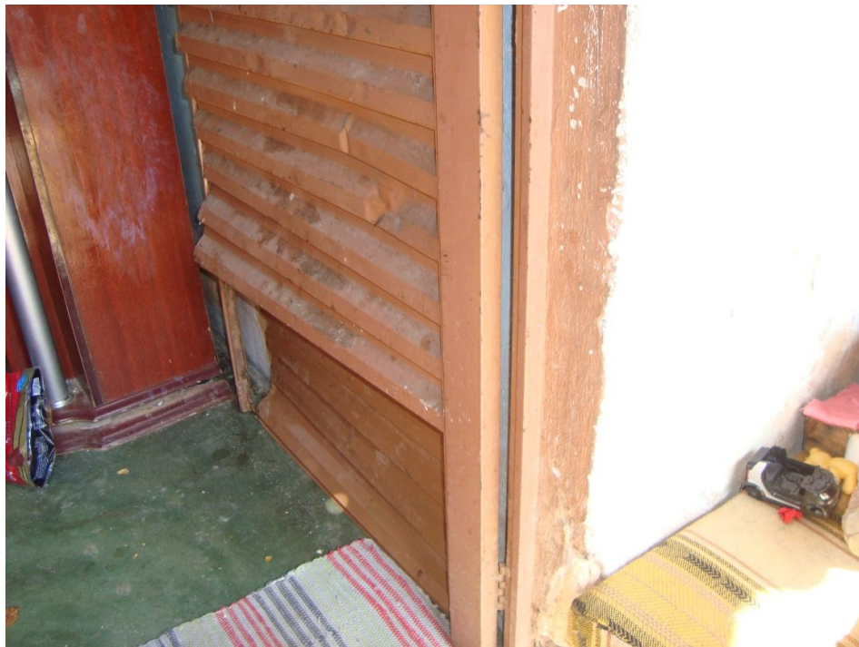
Fotografia 41 – Porta metálica danificada
