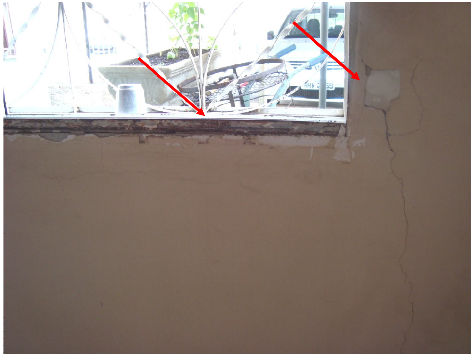
Fotografia 23 – Pintura danificada (destacamentos e trincas) junto à esquadria metálica também danificada de janela
