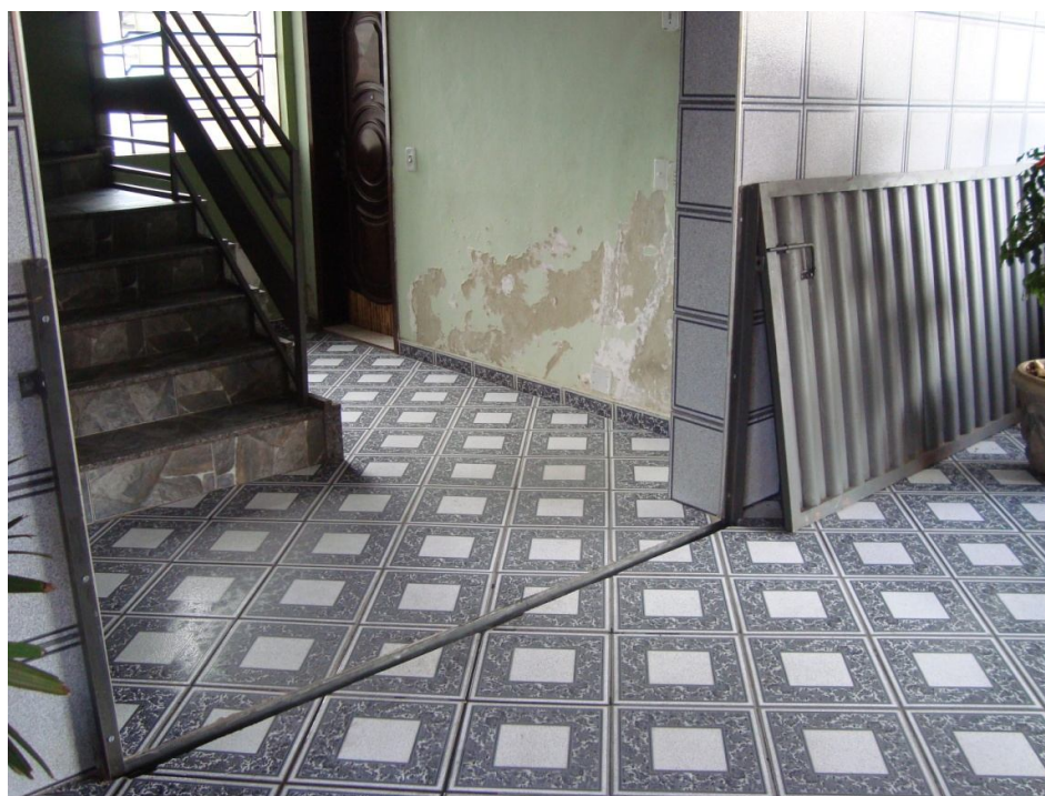
Fotografia 13 – Hall de entrada dos apartamentos térreos com comporta metálica e escada de acesso ao pavimento superior do C 43 – Paredes com pintura danificada
