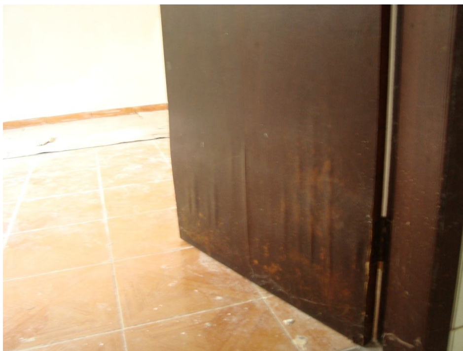
Fotografia 27 – Porta de madeira danificada na parte inferior
