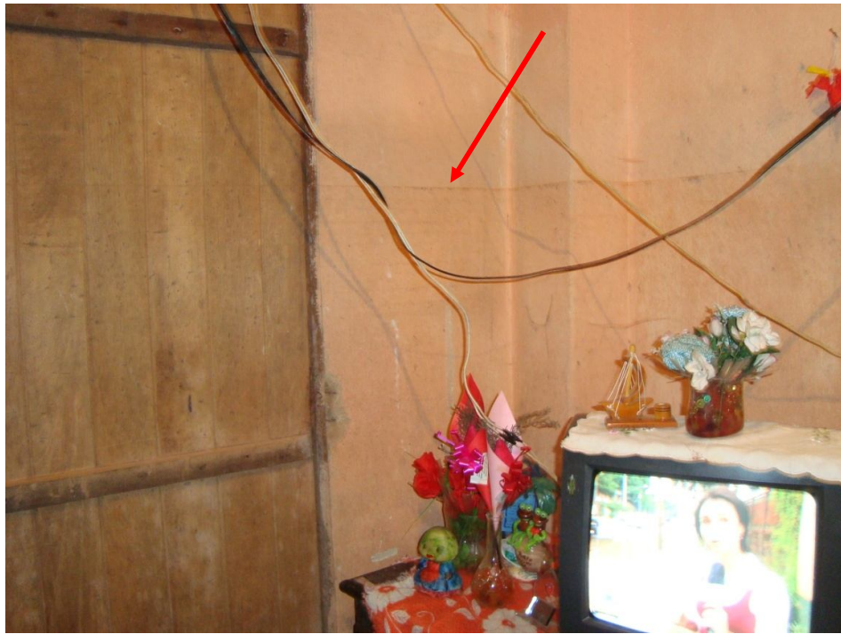
Fotografia 63 – Presença de manchas de umidade (marcas da inundação) nas paredes
