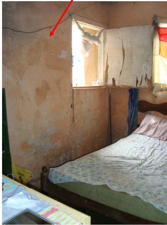
Fotografia 65 – Presença de manchas de umidade (marcas da inundação) nas paredes
