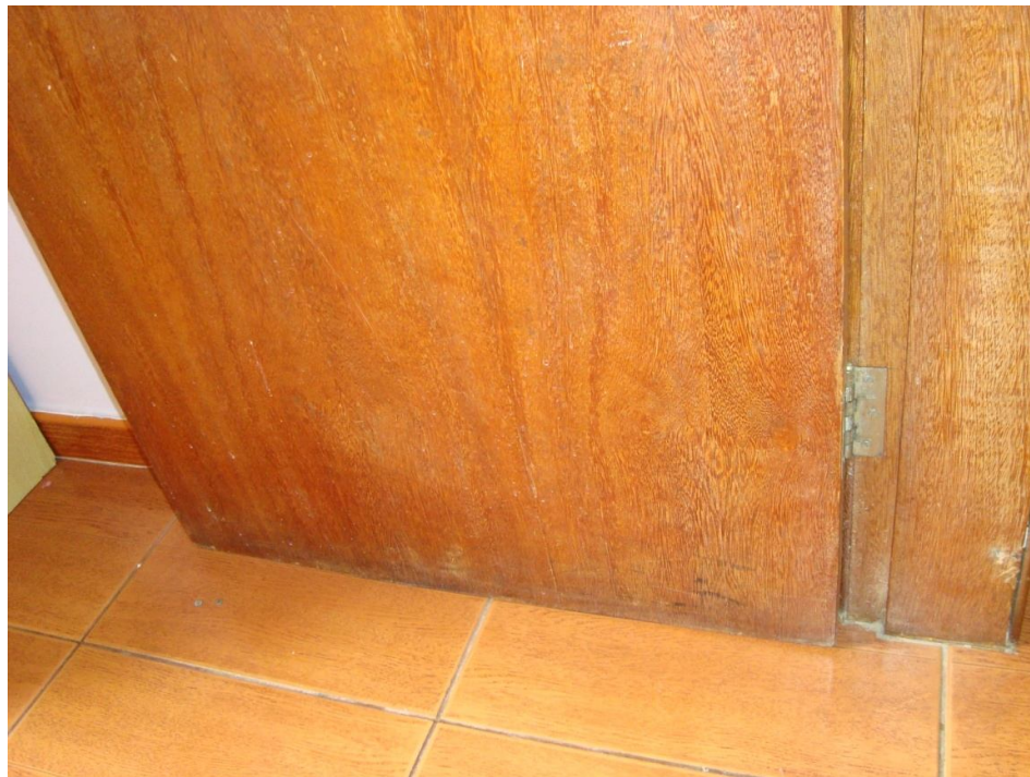
Fotografia 10 – Porta de madeira danificada na parte inferior
