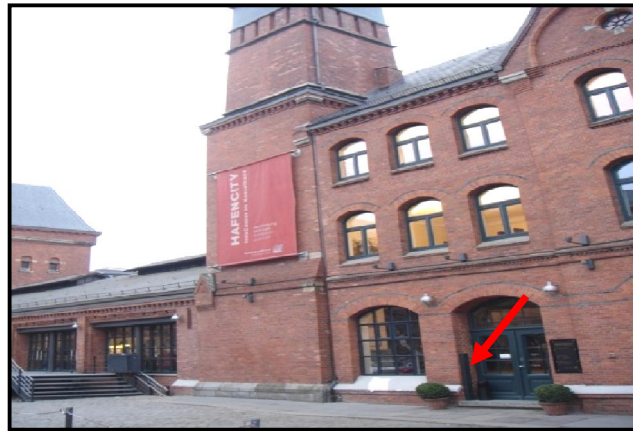
Figura 3.20 Comporta de madeira instalada em porta de entrada de prédio em Hafencity , na cidade de Hamburgo, Alemanha (Fotografia: Cristiane Parisi Jonov, 2011)
