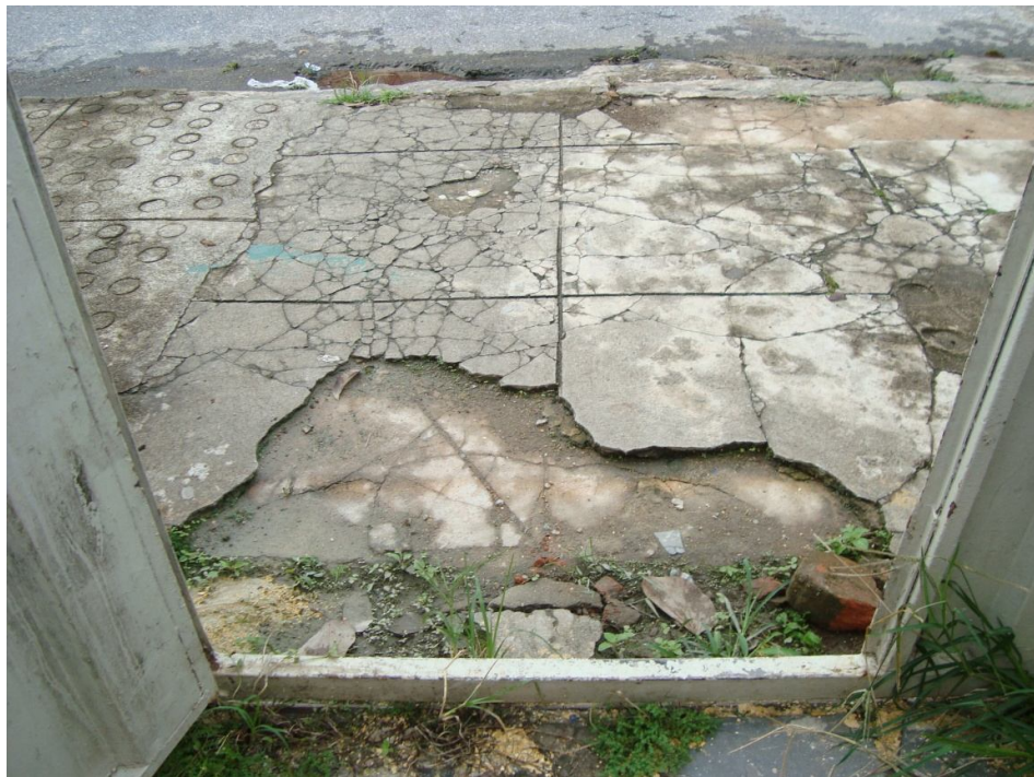
Fotografia 25 – Piso do passeio danificado
