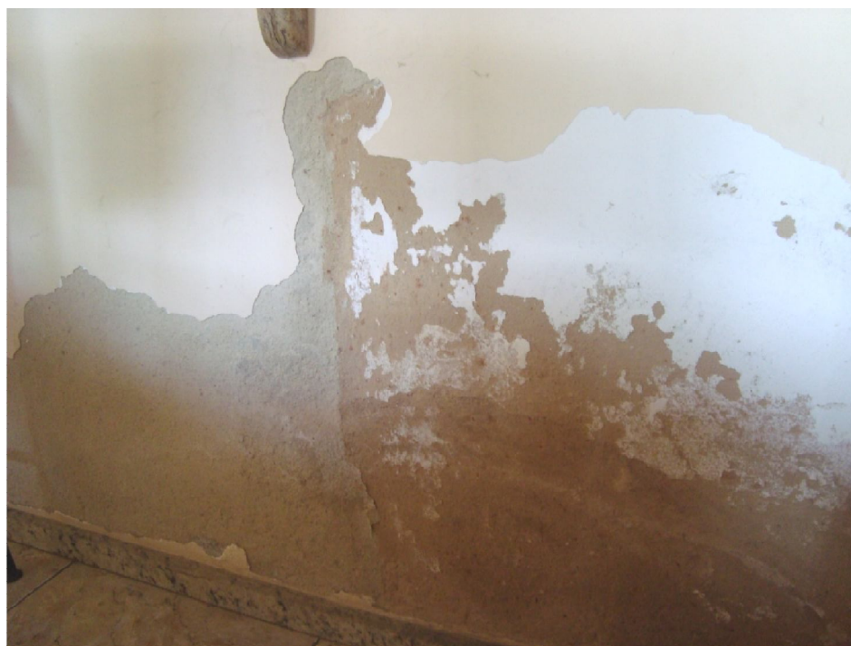
Fotografia 22 – Pintura danificada e esfacelamento do revestimento argamassado das paredes
