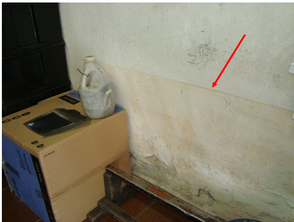
Fotografia 47 – Barbearia – Presença de manchas de umidade (marcas da inundação) nas paredes
