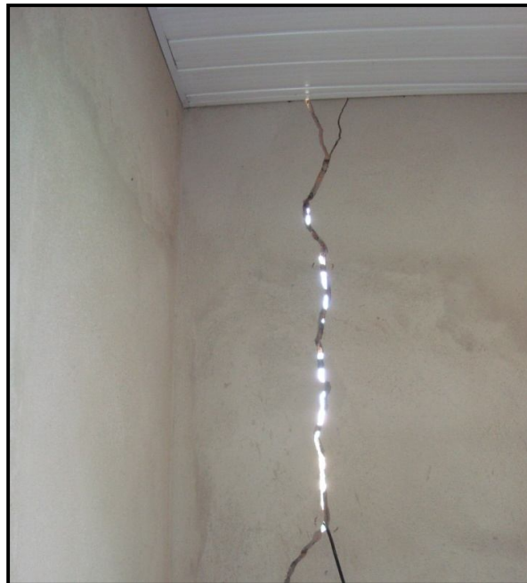
Figura 5.8 Rachadura em parede da edícula (casa 16)
