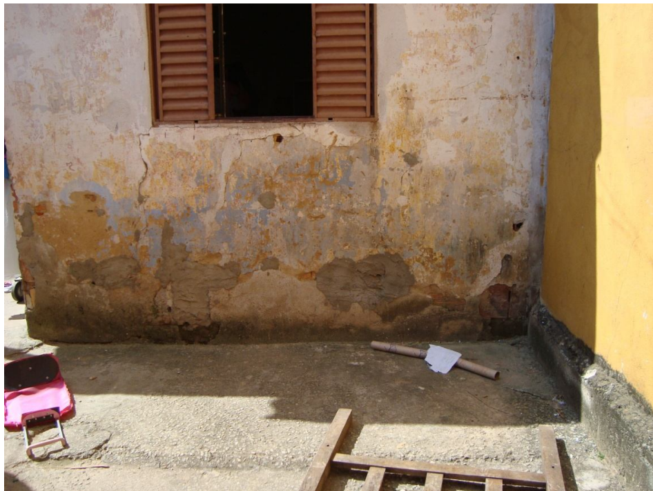
Fotografia 39 – Paredes externas danificadas
