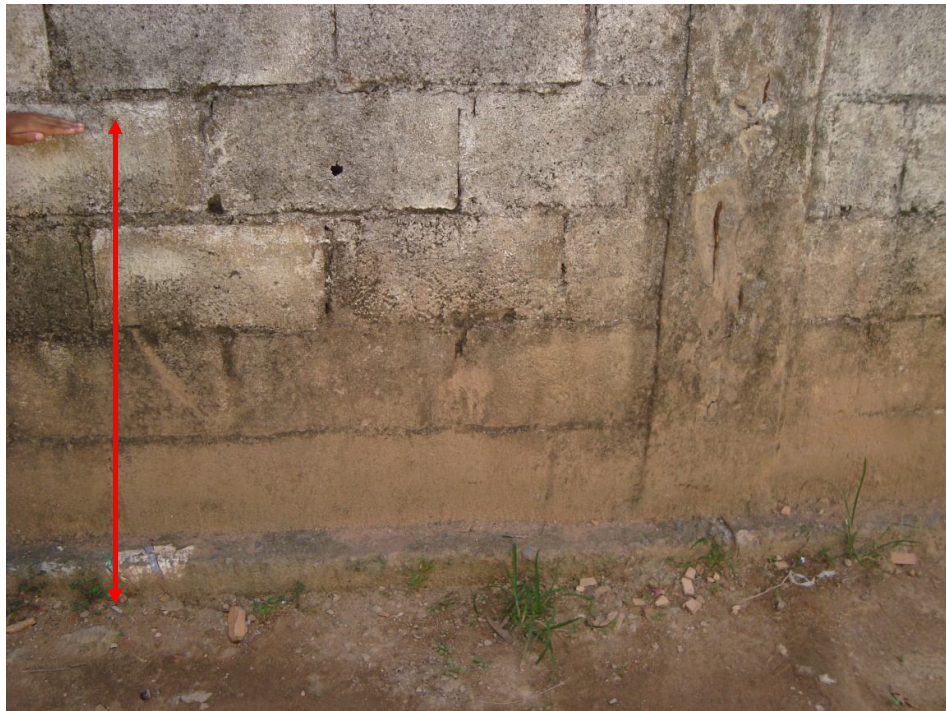
Fotografia 38 – Indicação da altura atingida pelas águas da inundação
