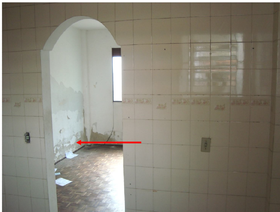
Fotografia 17 – Pintura danificada e esfacelamento do revestimento argamassado das paredes internas do apartamento
