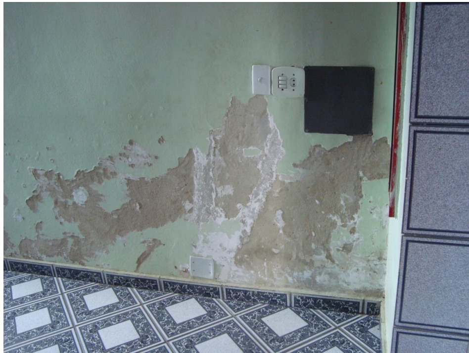
Fotografia 14 – Pintura danificada e esfacelamento do revestimento argamassado das paredes
