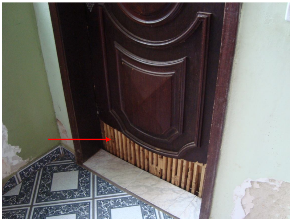
Fotografia 16 – Porta de entrada do apartamento danificada na parte inferior
