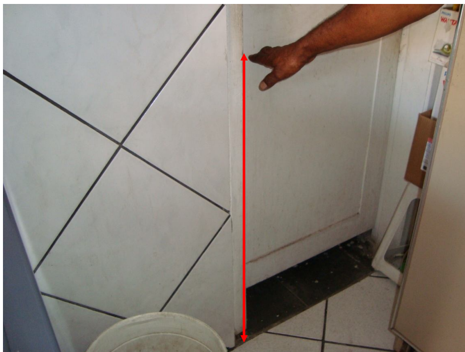
Fotografia 44 – Indicação da altura atingida pelas águas da inundação
