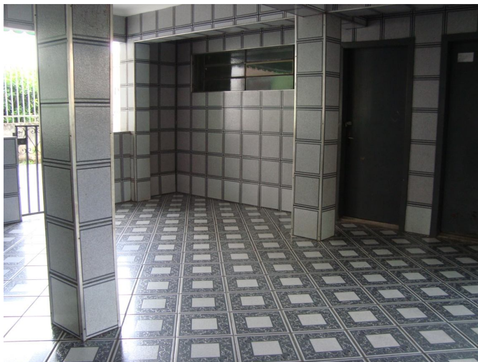
Fotografia 12 – Hall de entrada do bloco C 43 – Piso e paredes com revestimento cerâmico
