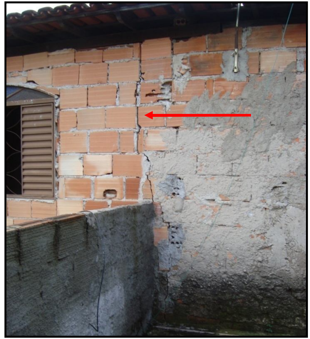
Figura 5.7 Presença de rachaduras em paredes de edícula existente junto ao rio (casa 16)
