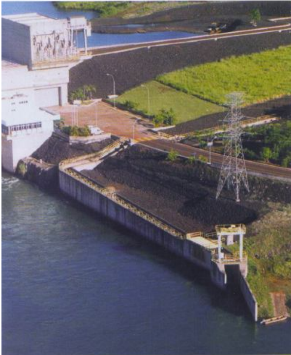
Figura 9: Sistema de Tranposição de peixes - escada de peixes da Usina de Igarapé, rio Paraopeba, MG. Foto: Carlos Bernardo Mascarenhas.
