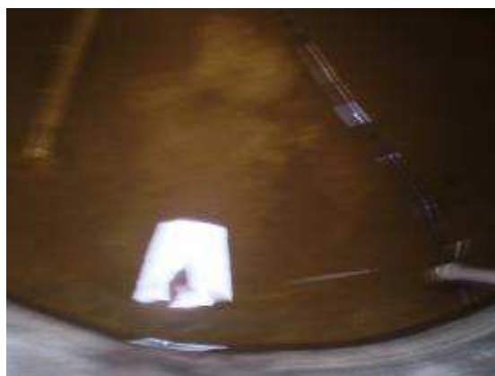
Figura 5.18 (h) – Água com cor e turbidez significativas, outros materiais dentro da cisterna e altura baixa do nível da água.
