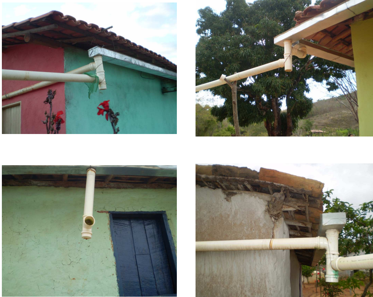
Figura 5.11 – Aplicação do “cap” para desvio da primeira água de chuva.
