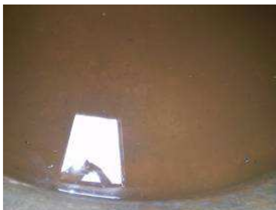
Figura 5.18 (t) – Água com cor e turbidez elevadas, baixo nível da água e alguma sujeira no fundo e sobre a água.
