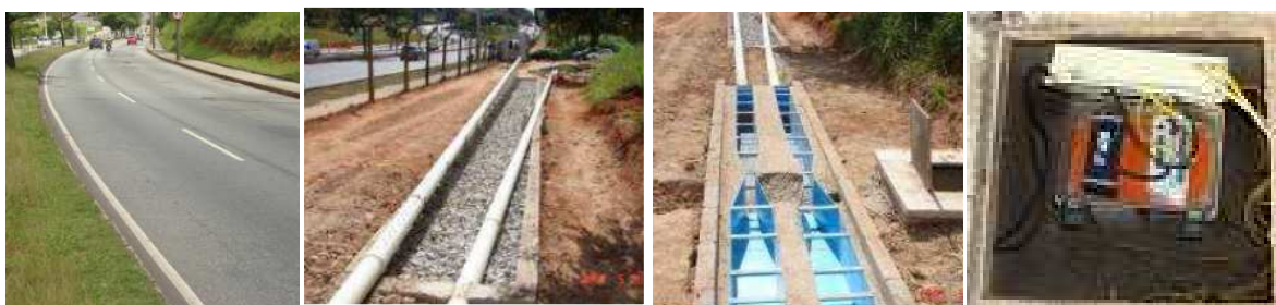
Figura 26 – Sítio 1 – Estação Ecológica UFMG (da esquerda para a direita: área de drenagem, trincheira de infiltração, medidor de vazão de entrada, data-logger)
