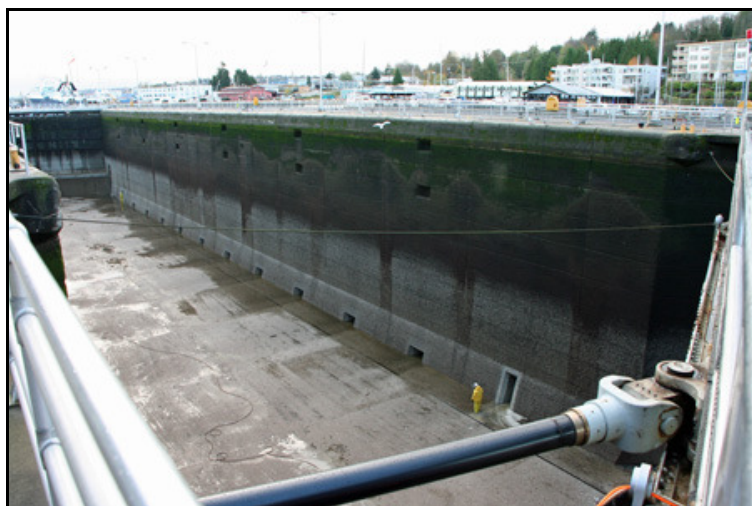
Figura 3.5 – Foto da eclusa Hiram M. Chittenden Locks com sistema de enchimento lateral Fonte: Swedes (2009)
