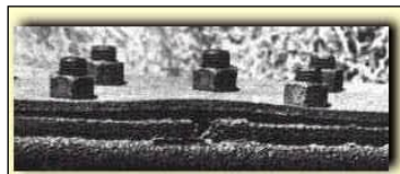
Figura 8 – Corrosão em frestas (CASTRO, 2011).
