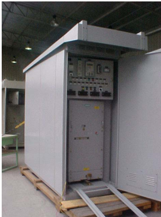
Fig. 47 - Cubículo Com Disjuntor a Vácuo de 36 kV
