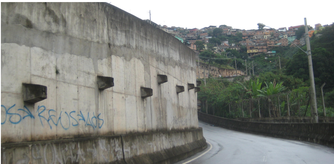
Figura 31. Aglomerado da Serra: Via do Cardoso conformada por taludes e muros de arrimo.
