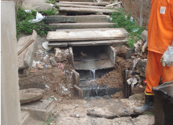
Figura 47. Esgoto correndo pela ERD no bairro Calabar em Salvador
