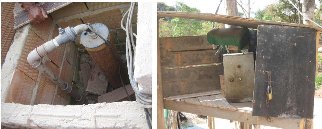
Figura 21. Bairro Roma: bomba para captação de água em poço e quadro de comando Fonte: fotos do autor, 2012.
