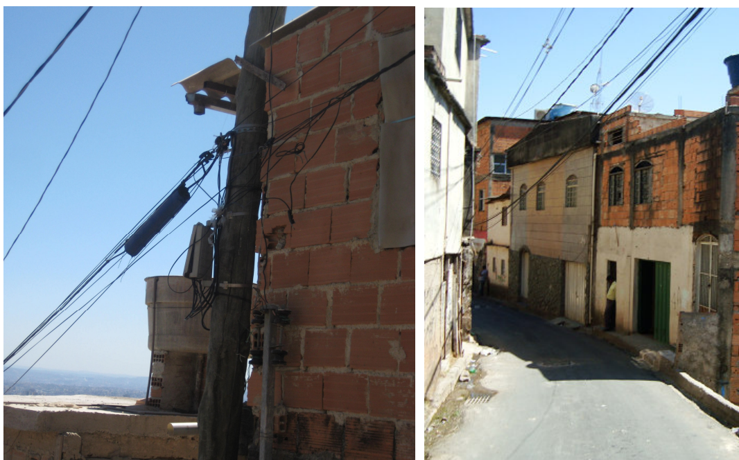
Figura 51. Aglomerado da Serra: poste e distribuição da fiação elétrica
