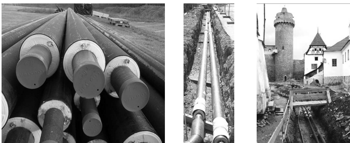
FIGURA 1.3 – Inserção de tubulações em sistemas distritais – Munique, Alemanha. FONTE - SPIRKL, 1997.
