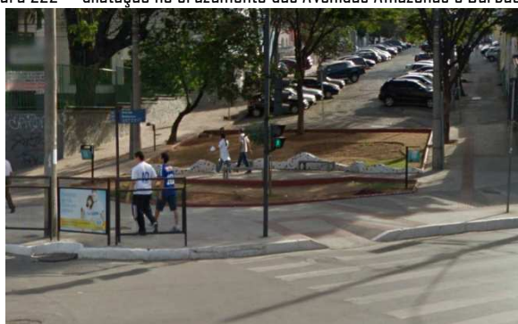
Figura 222 - -dilatação no cruzamento das Avenidas Amazonas e Barbacena.
