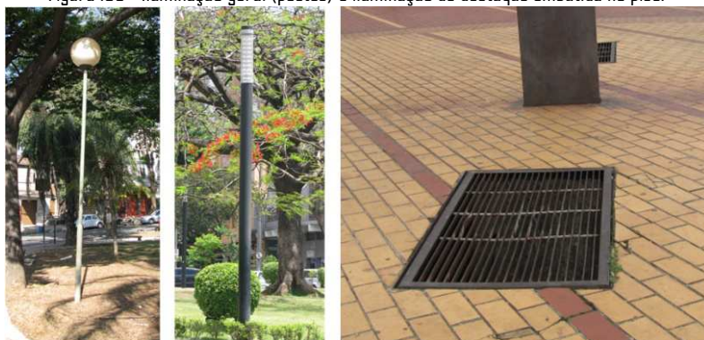
Figura 139 - Iluminação geral (postes) e iluminação de destaque embutida no piso.
