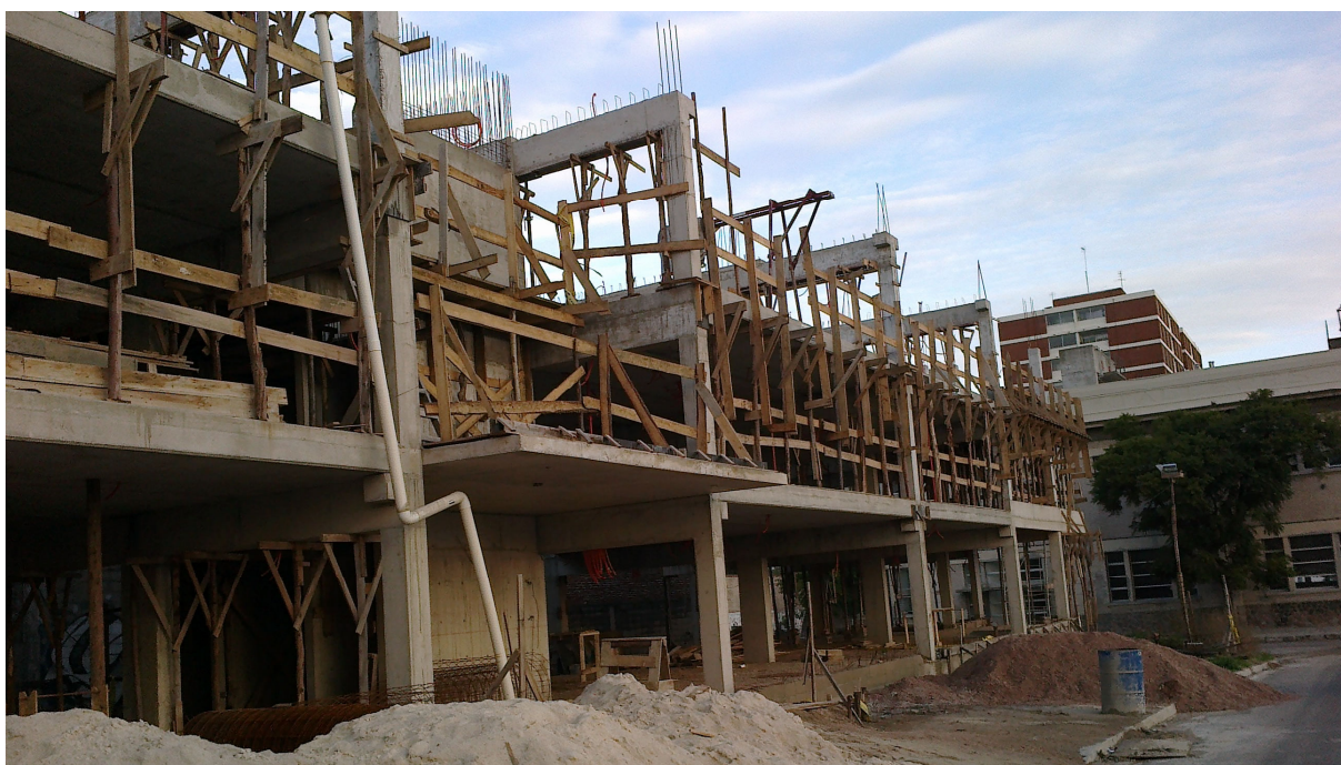
Fotografia 17 – Estrutura em concreto pré-fabricado na construção de uma cooperativa habitacional de proprietários por ahorro previo – Montevideu / Uruguai
