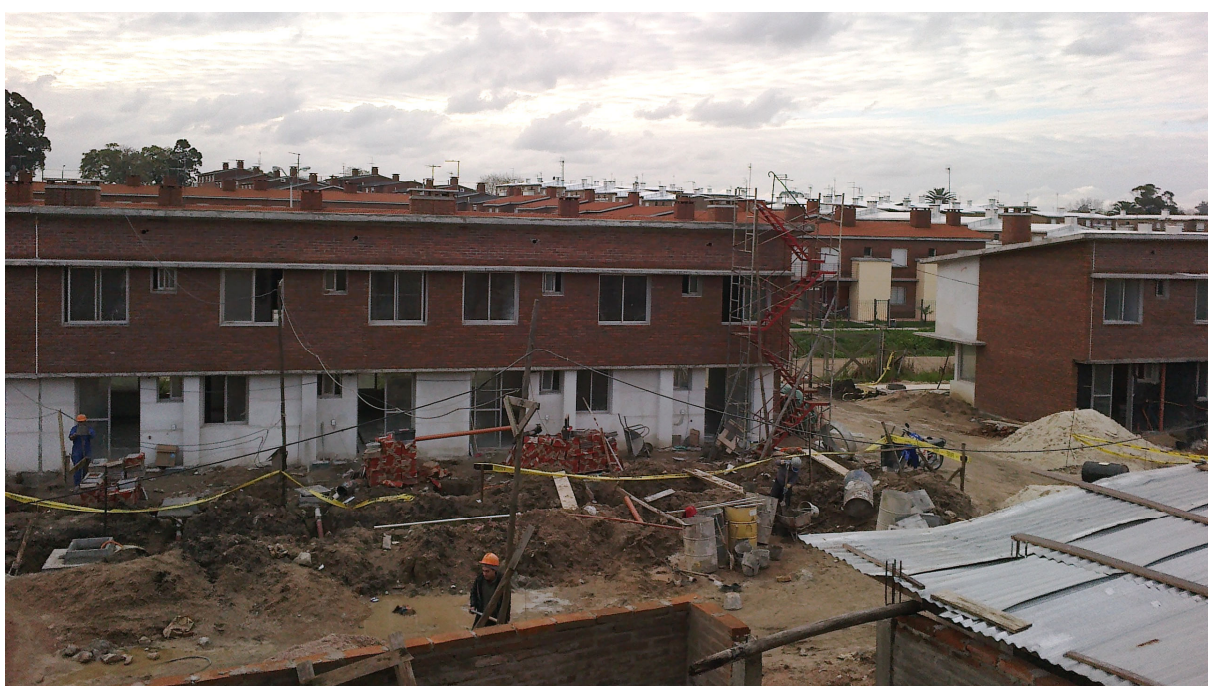
Fotografia 15 – Canteiro de obras de cooperativas contemporâneas habitacionais de usuários por ayuda mutua – Montevidéu / Uruguai
