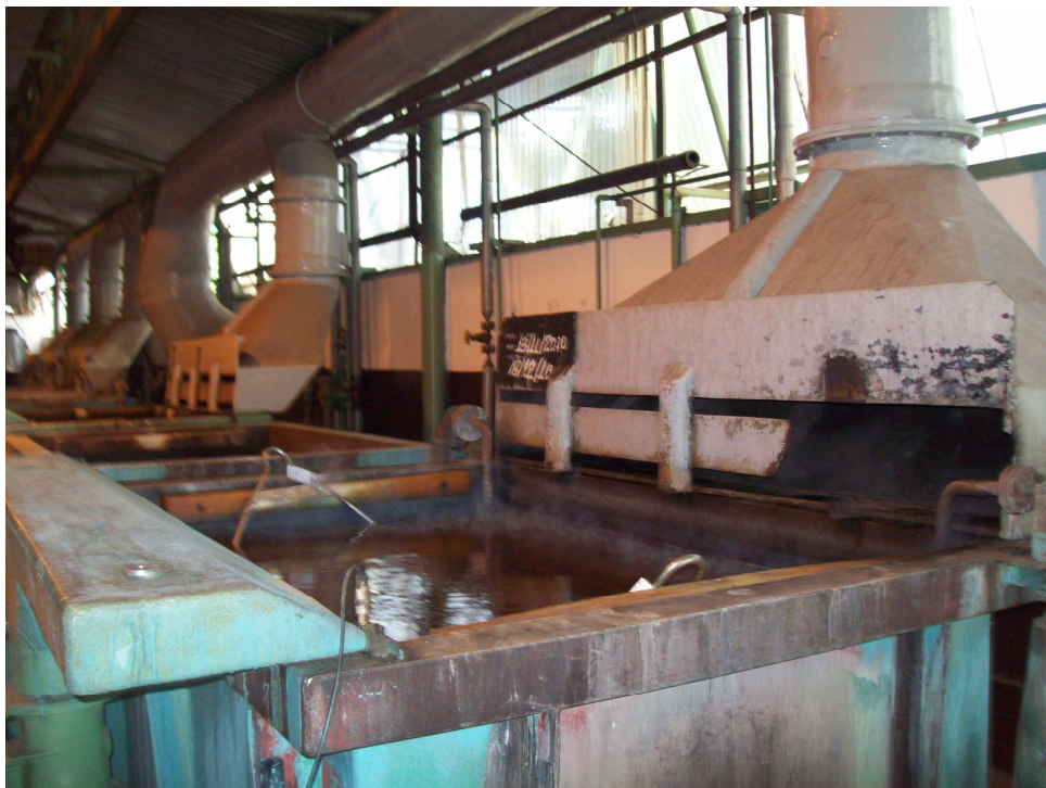
Figura 11: Tanques para banhos de tratamento superficial por imersão. Autor : Ana Lúcia Félix. Nov, 2010.
