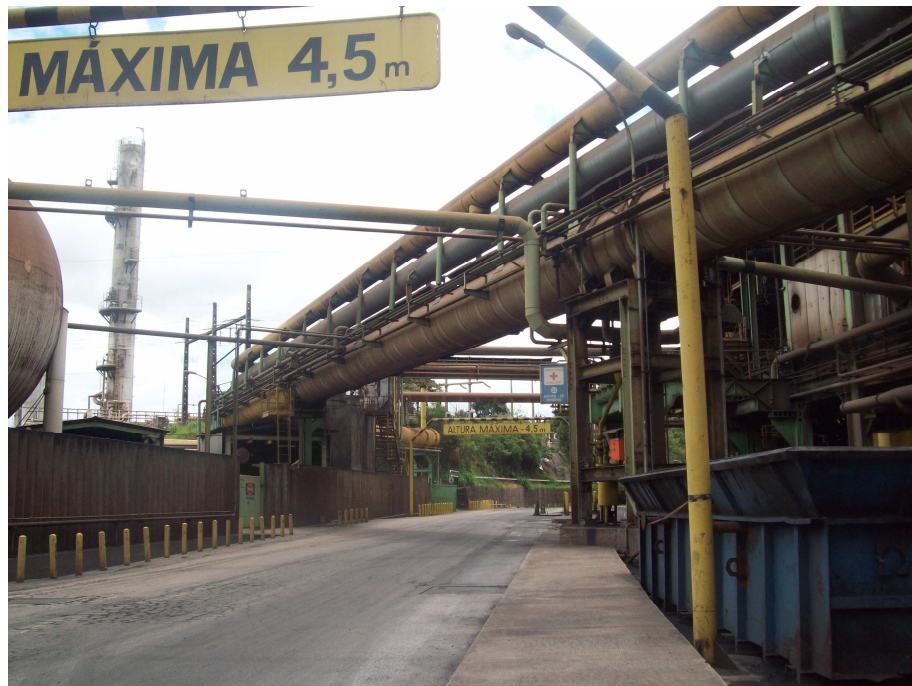
Figura 9: Captação de Água do Sistema Catarina Autor : Ana Lúcia Félix. Nov, 2010.
