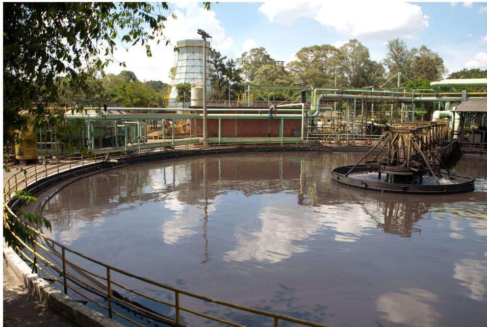
Figura 6: Decantador da Estação de Tratamento de Efluentes. Autor: Ana Lúcia Félix. Nov, 2010.
