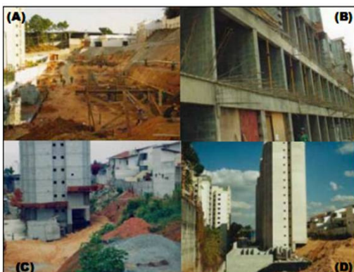
Figura 2.2 (A) Terreno muito acidentado; (B) Paredes estruturais chegando até a fundação, minimizando transições; (C e D) Paredes estruturais usadas como arrimo.
