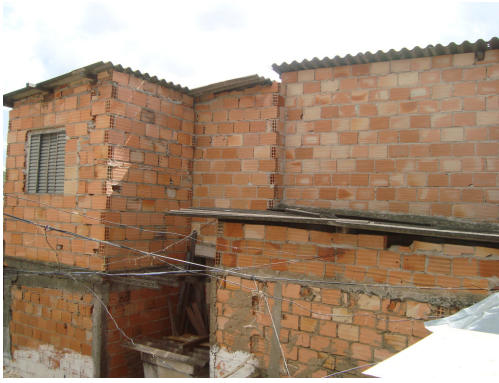
Figura 2.5: Ausência de estrutura de viga e pilar – residência no Aglomerado da Serra
