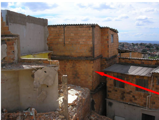
Figura 1.1: Casas construídas sem o uso de pilares e vigas de concreto armado - Aglomerado da Serra.
