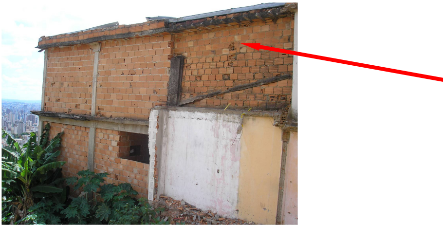
Figura 2.4: Uso do pilar de concreto sem cintamento abaixo da laje – residência no Aglomerado da Serra
