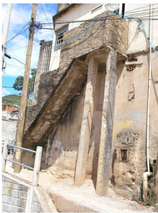
Figura 2.6: Construções com superdimensionamento de estruturas - residência no Aglomerado da Serra.
