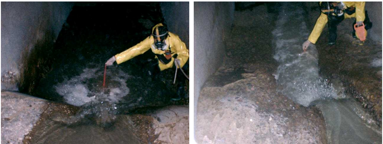
Figuras 4.15 e 4.16 – Desgaste por erosão e cavitação em degraus. Nota-se pelo bastão na mão do vistoriador que a grande profundidade da erosão abaixo do leito do canal.
