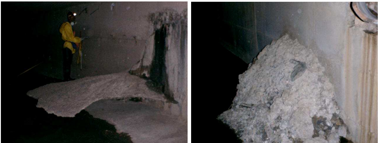
Figuras 4.59 e 4.60 – Presença de concreto dentro das galerias. A presença tanto pode ser originada de descarte irregular de material nas redes quanto de defeitos nas formas durante a execução das estruturas.
