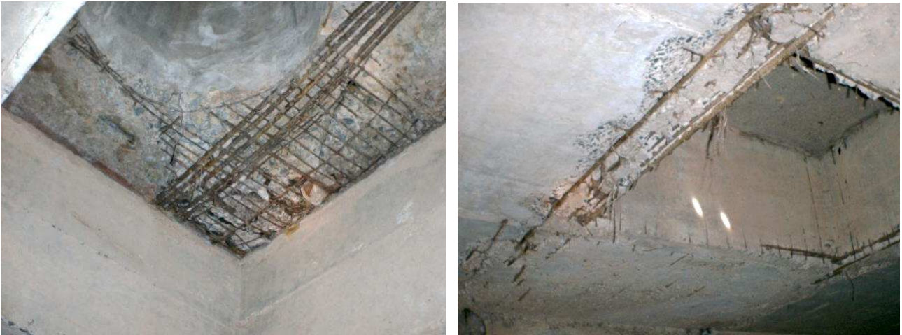
Figuras 4.25 e 4.26 – Corrosão das armaduras nas lajes de teto de galeria, junto a poços de visita. Nota-se que houve o deslocamento do recobrimento de concreto destas armaduras, em virtude da expansão a armadura corroída.
