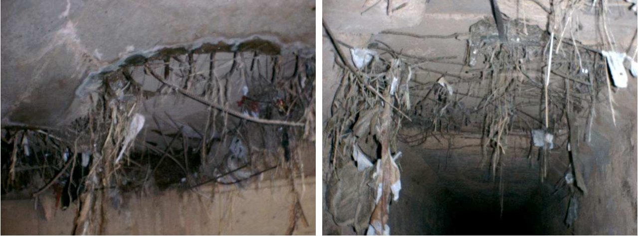
Figuras 4.33 e 4.34 – Corrosão generalizada das armaduras em lajes de teto de galeria, propiciando o acúmulo de lixo preso nas ferragens. Ambientes agressivos como os canais fechados, onde existem gases, líquidos ou sólidos agressivos, ou mesmo solos agressivos, proporcionam condições para a corrosão de armadura no concreto armado
