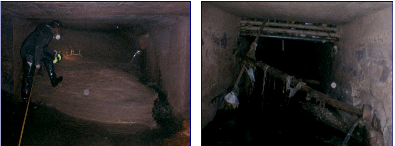
Figuras 4.39 e 4.40 – A primeira figura mostra a presença de grande quantidade de concreto lançado dentro do canal, provavelmente proveniente da execução de fundações de edificações acima deste. A seção do canal é case totalmente estrangulada pelo material. A Figura 4.40 mostra a presença de redes de utilidades dentro dos canais. Além de danificar as paredes e tetos a estrutura, propicia o acúmulo de lixo, além de interferir no funcionamento dos canais.
