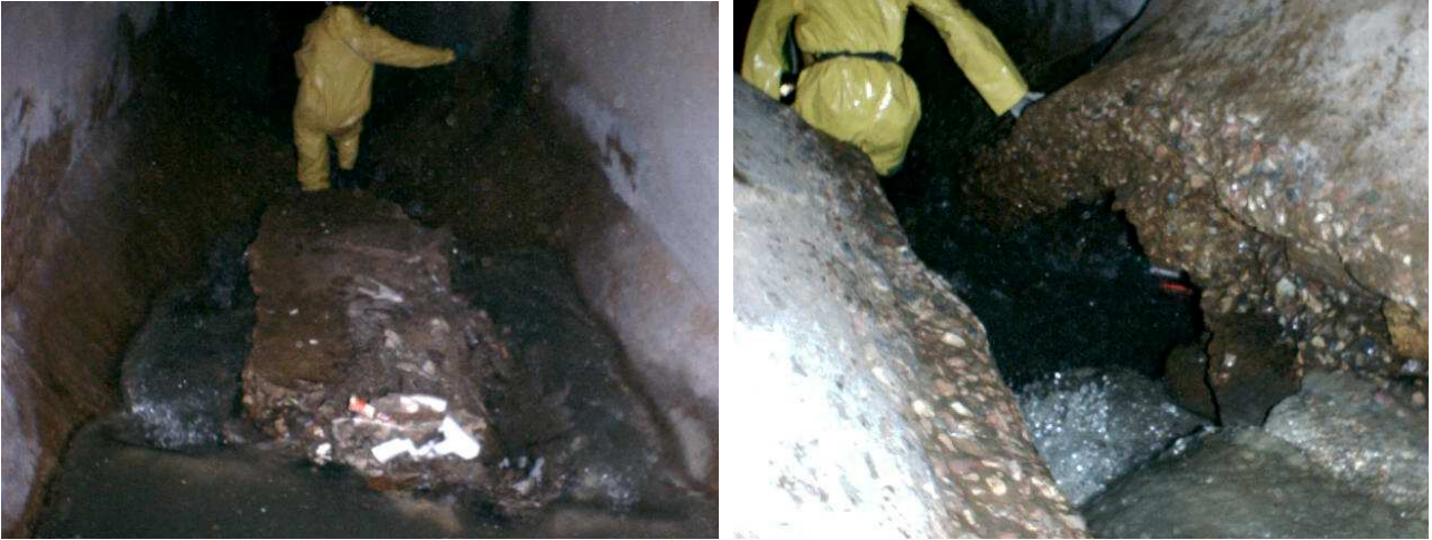
Figuras 4.21 e 4.22 – Desgaste por erosão no fundo de galerias. O fundo da galeria foi completamente erodido e não mais existe. Tal condição pode inclusive levar a estrutura à ruína, uma vez que há o solapamento da estrutura do canal devido ao fluxo d'água que passa a ocorrer em leito natural, já que não mais existe laje de fundo.
