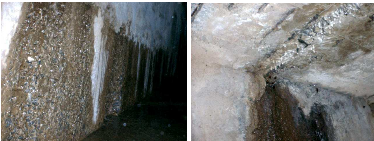
Figuras 4.43 e 4.44 – Manchas e estalactites decorrentes de lixiviação acentuada, causada pelo carreamento de material causado pelo fluxo d'água dentro das estruturas de concreto. Tais manchas, comuns em estruturas de túneis de concreto, caixas de água e valas, onde ocorre a livre percolação de água, diminuem a proteção química e o pH do concreto, e em alguns casos, formam estalactites decorrentes de lixiviação acentuada.
