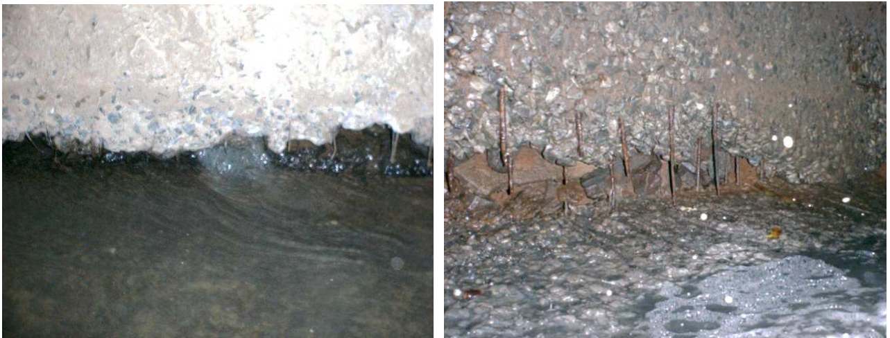
Figuras 4.19 e 4.20 – Desgaste na junção da laje de fundo com as paredes dos canais, ponto vulnerável. Nota-se que já se iniciou o processo de corrosão das armaduras. Na maioria dos casos, como este, nota-se que a deterioração da estrutura devido a determinada patologia é a porta de entrada para o desenvolvimento de outras patologias. O processo acaba se retroalimentando levando a estrutura a deterioração acentuada ou até mesmo à ruína.
