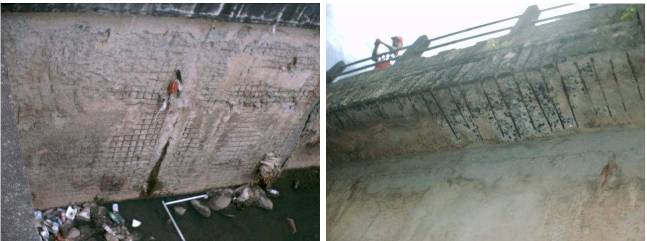
Figuras 4.27 e 4.28 – Corrosão generalizada das armaduras na parede de canal aberto, no caso o Arrudas e no fundo de passeio conjugado ao canal. A corrosão eletroquímica da armadura do concreto pode ocorrer devido à falta de uniformidade do aço (diferentes aços, soldas), do contato com metais com menor potencial eletroquímico, assim como da heterogeneidade do meio físico e químico que rodeia o aço. Quando as condições de serviço se modificam, e o concreto se altera através da penetração de substâncias agressivas, ocorre o rompimento da película passivante, e inicia-se a corrosão das armaduras. Os óxidos expansivos, gerados na corrosão, ocupam um volume várias vezes maior que o volume do aço original, causando fissuras e destacamento da camada de cobertura, facilitando o ingresso de mais agentes agressivos.
