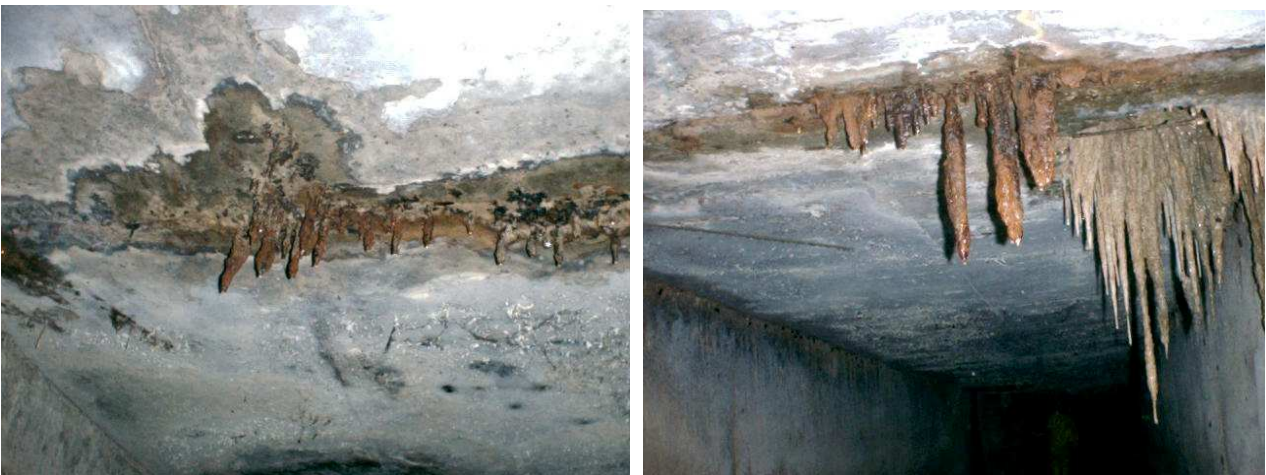
Figuras 4.35 e 4.36 - Estalactites formadas pelo carreamento de material causado pelo fluxo d'água dentro das estruturas de concreto. Pode-se notar pela cor a presença de material das armaduras, além da presença de carbonatação e efluorecências.
