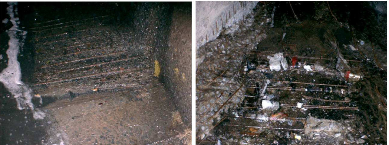
Figuras 4.23 e 4.24 – Desgaste acentuado de laje de fundo de galeria com exposição das armaduras e sua subsequente corrosão. Nota-se na segunda figura que a exposição das armaduras faz com que o lixo carreado pelo fluxo fique preso nesta.
