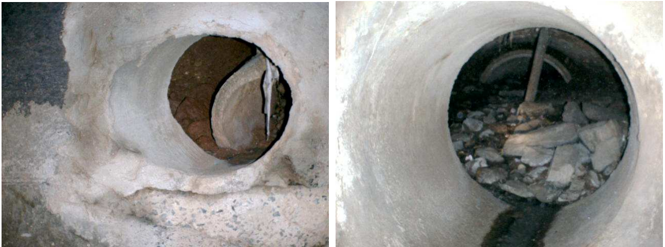
Figuras 4.57 e 4.58 – Colapso de manilhas de concreto pré fabricadas em rede de drenagem, causada pelo solapamento do solo abaixo das manilhas. Uma vez que as manilhas se deslocam ou entram em ruína, o fluxo d'água diretamente no solo abaixo causado pela falta da rede retroalimenta o processo de carreamento de material e cada vez mais manilhas são atingidas.
