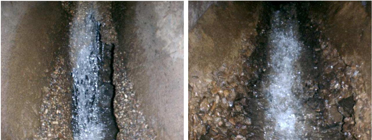
Figuras 4.17 e 4.18 – Desgaste por erosão no fundo de redes tubulares de concreto. A erosão é o desgaste causado pela passagem abrasiva dos fluidos contendo partículas sólidas finas suspensas. Há o aumento do efeito erosivo em concretos quando a água contém ácidos e sais reagentes com elementos do cimento dissolvido. A presença de ligações clandestinas de esgoto e lançamentos indevidos nas redes propiciam tal situação.
