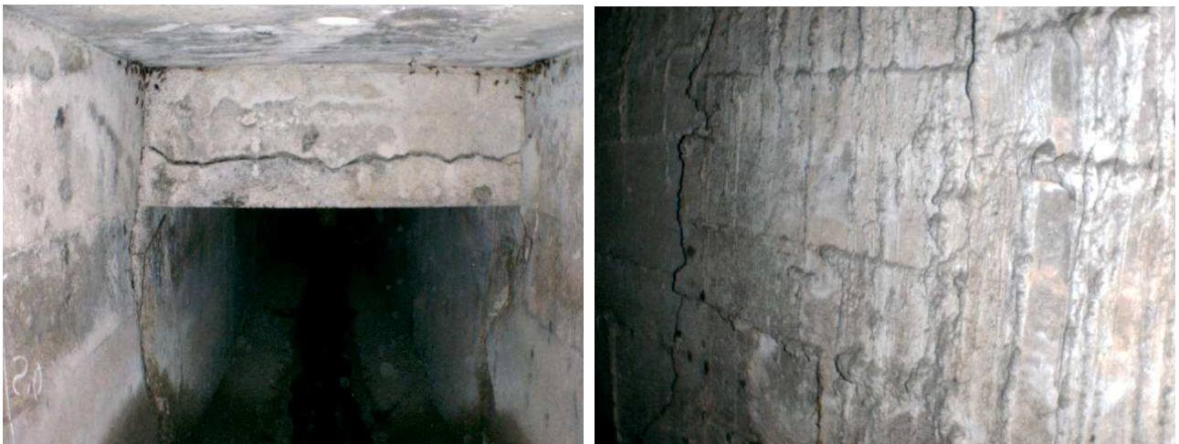
Figuras 4.55 e 4.56 – Presença de trincas nas estruturas de galerias A fadiga provoca o aumento da deformação, obtida através da aplicação repetida de uma carga ao longo de um tempo. Tensões cíclicas e carregamentos repetitivos inferiores à tensão máxima resistente podem provocar ruptura por fadiga nas estruturas.
