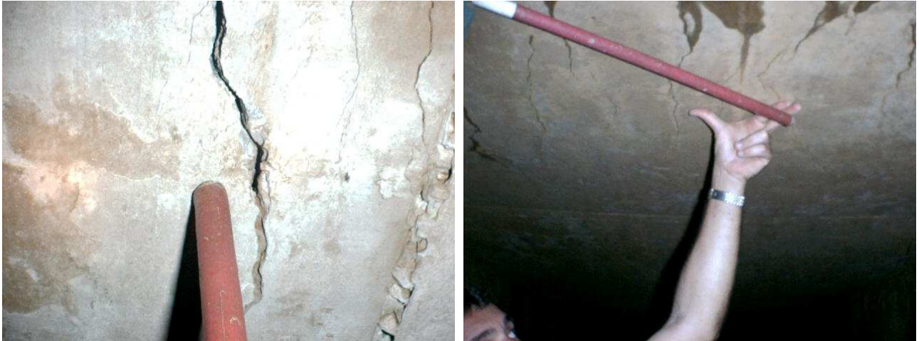
Figuras 4.53 e 4.54 - Presença de trincas nas estruturas de galerias O concreto sob carga pode estar sujeito a três tipos de deformação: elástica, plástica e viscosa. Podem ocorrer também combinações entre elas. A deformação elástica, ou imediata, é reversível e pode ser totalmente recuperada quando do descarregamento do concreto. Já a deformação lenta, ou por fluência, refere-se a uma deformação parcialmente reversível, plástica.
