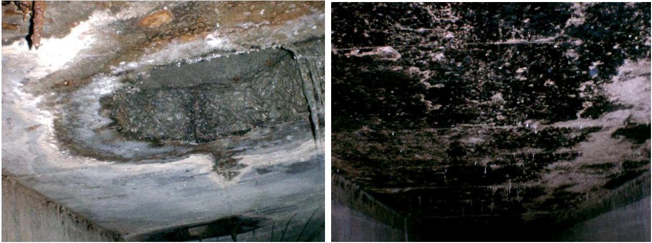
Figuras 4.37 e 4.38 – Manchas brancas indicando a presença de eflorescências. Nota-se também a presença de estalactites, o que mostra que houve carreamento de material de dentro da estrutura. As reações químicas no concreto se manifestam através de efeitos físicos nocivos, tais como o aumento da porosidade e permeabilidade, diminuição da resistência, fissuração e destacamento. Atenção especial deve ser dada ao ataque de sulfatos, ataque por álcali-agregado e corrosão das armaduras, uma vez que estes fenômenos são responsáveis pela deterioração de um grande número de estruturas de concreto.
