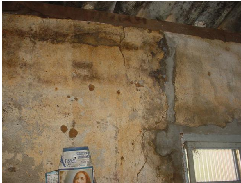
Figura 4.21 Problemas com umidade Fonte ( Prefeitura Municipal de Brumadinho)
