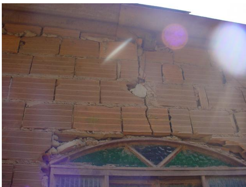
Figura 4.18 Defeito de Execução parede com trinca devido falta de vergas ou cinta de amarração Fonte ( Prefeitura Municipal de Brumadinho)
