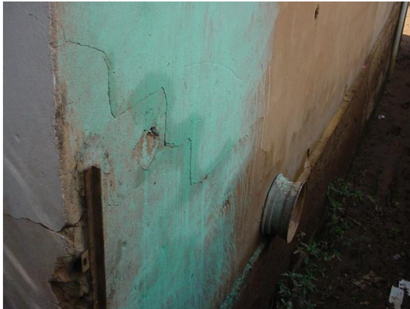
Figura 4.22 Problemas de recalque das fundações Fonte ( Prefeitura Municipal de Brumadinho)
