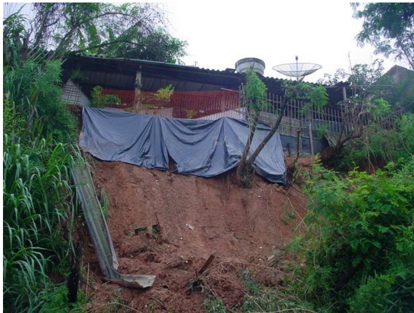
Figura 4.25 Problemas com desmoronamento de taludes Fonte ( Prefeitura Municipal de Brumadinho)
