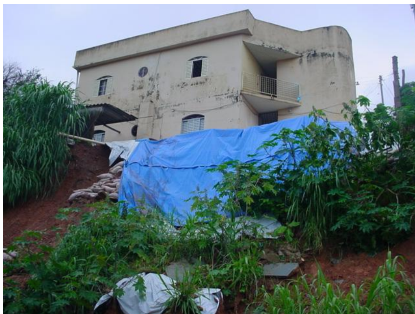
Figura 4.26 Problemas com desmoronamento de talude Fonte ( Prefeitura Municipal de Brumadinho))
