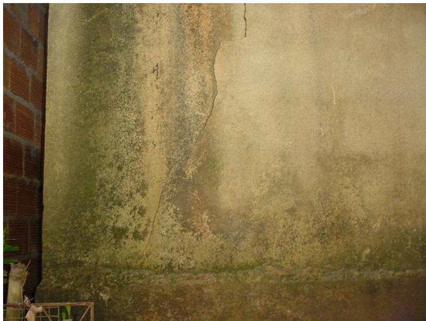
Figura 4.19 Problemas com umidade Fonte ( Prefeitura Municipal de Brumadinho)
