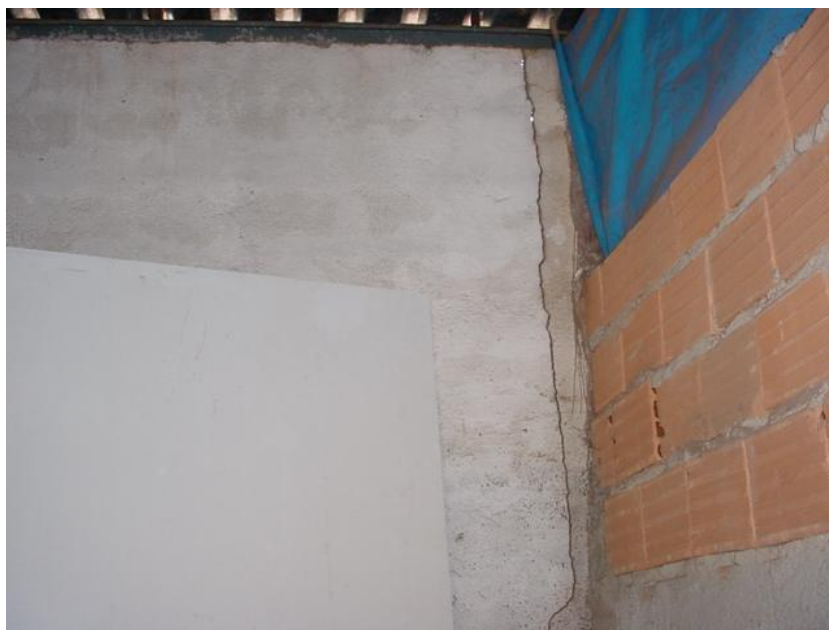
Figura 4.23 Trincas devido a movimentação do solo Fonte ( Prefeitura Municipal de Brumadinho)
