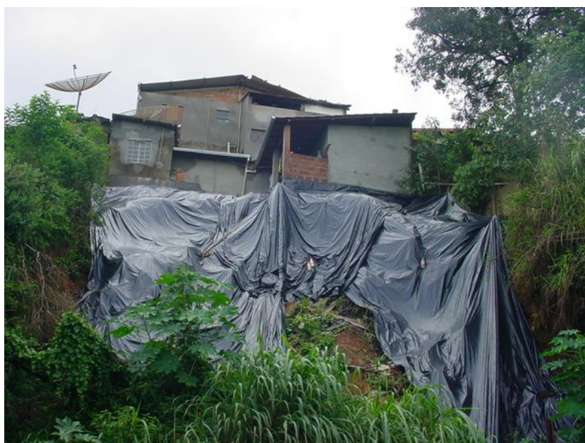
Figura 4.27 Problemas desmoronamento de Taludes Fonte ( Prefeitura Municipal de Brumadinho)
