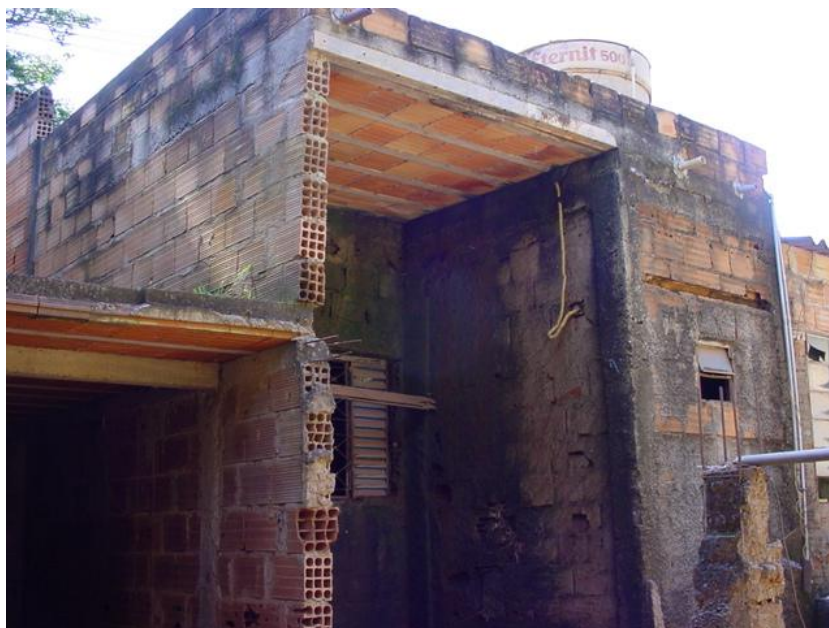
Figura 4.17 Defeitos de Execução paredes sem Prumo, reboco, esquadro Fonte ( Prefeitura Municipal de Brumadinho)
