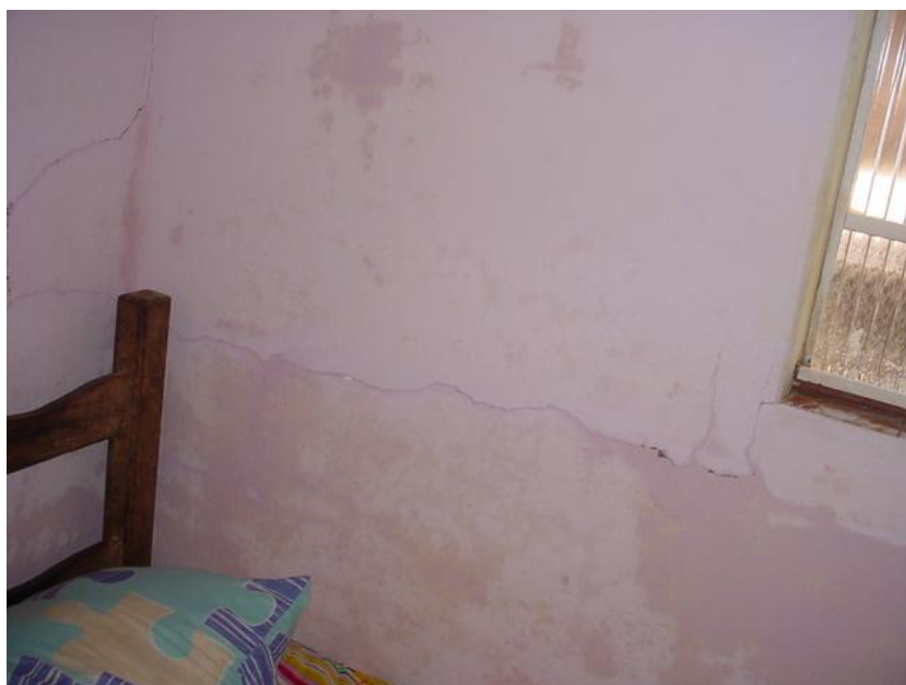
Figura 4.20 Problemas com umidade Fonte ( Prefeitura Municipal de Brumadinho)
