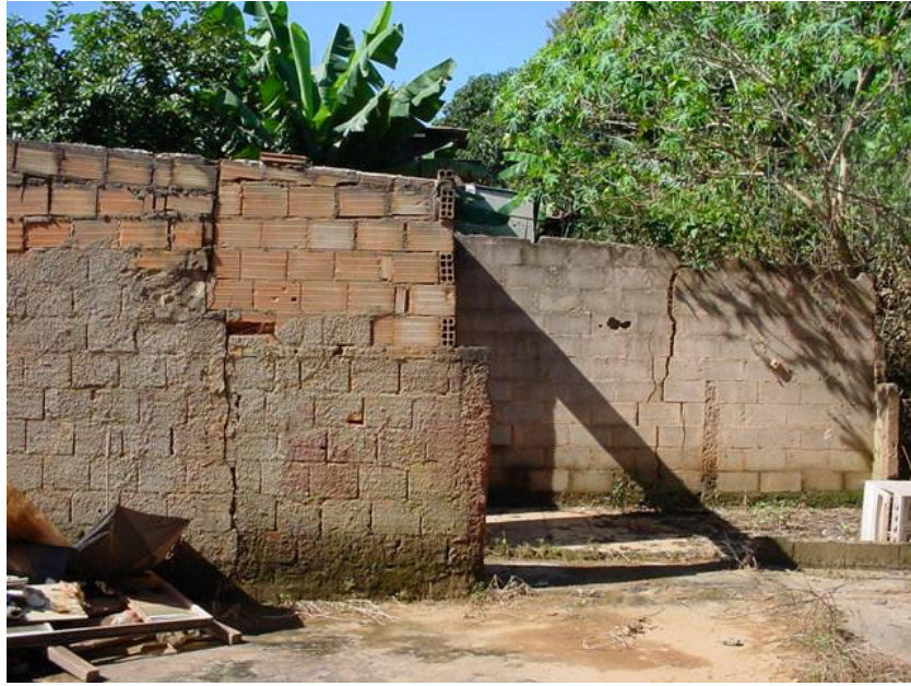
Figura 4.24 Trincas devido a Movimentação do solos Fonte ( Prefeitura Municipal de Brumadinho)
