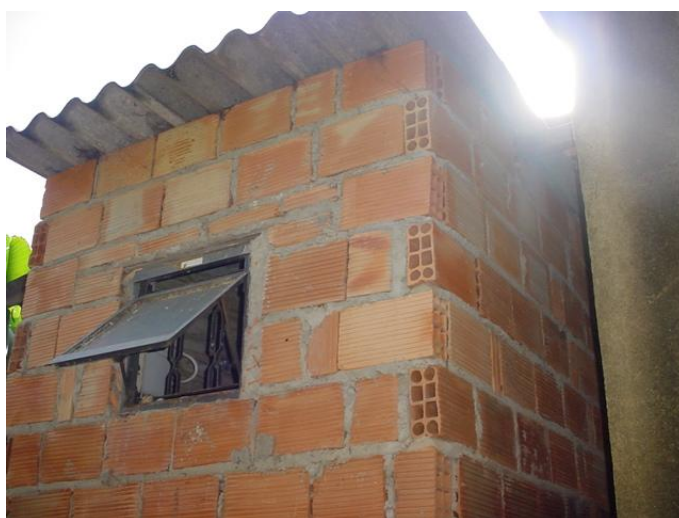
Figura 4.16 Defeitos de Execução paredes sem Prumo, reboco, esquadro Fonte ( Prefeitura Municipal de Brumadinho)
