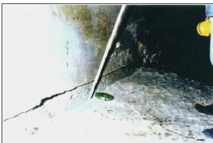
Figura 4.22: Recalque da laje de fundo de uma galeria. Fonte: (AGUIAR & BAPTISTA, 2009)
