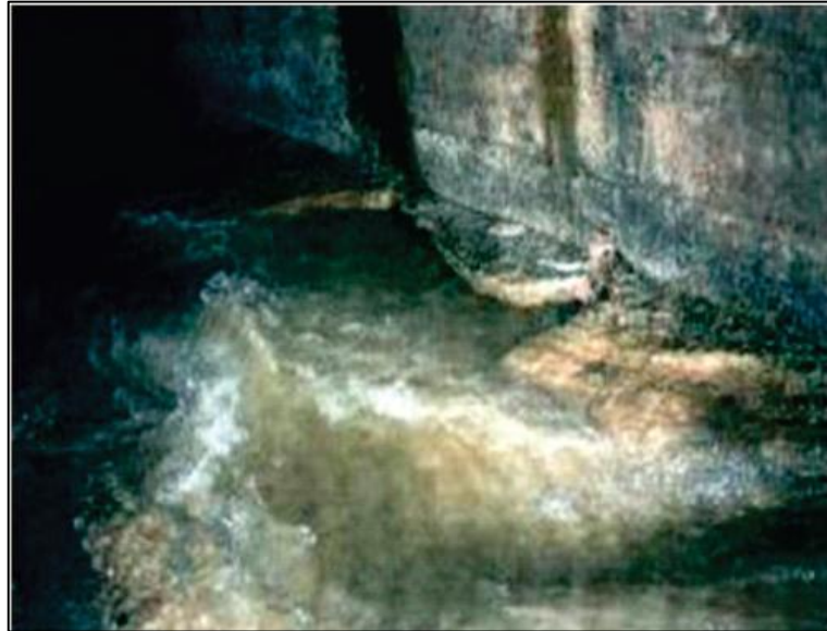
Figura 4.1: Deterioração causada por abrasão em galeria. (Fonte: AGUIAR & BAPTISTA, 2011)
