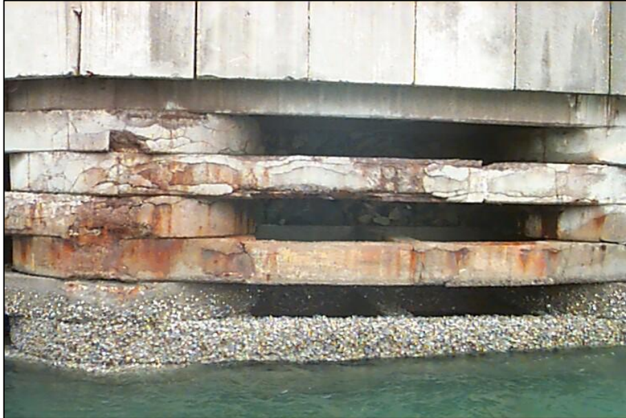
Figura 3.24: Cracas na linha d'água protegendo as estruturas marinhas, inibindo assim o processo de corrosão das armaduras. Fonte: (AGUIAR, 2006)
