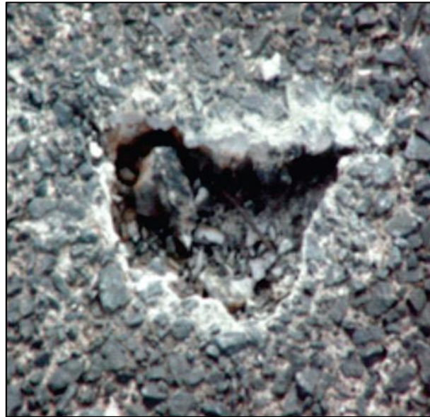
Figura 4.5: Efeito da cavitação em estrutura hidráulica de concreto. Fonte: (MACINNIS et al. , 1997 In: AGUIAR, 2006)
