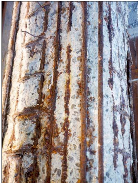
Figura 3.19: Pilar deteriorado devido aos efeitos da interação da carbonatação com íons de cloreto. Fonte: (AGUIAR, 2006)
