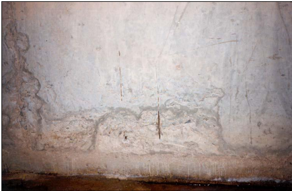
Figura 3.1: Excesso de altura do lançamento de concreto provocou a segregação do mesmo. Fonte: (AGUIAR, 2006)
