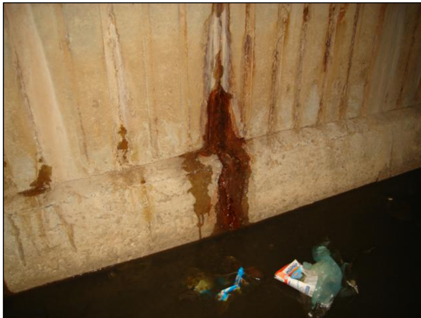
Figura 4.19: Infiltrações pelas paredes de uma galeria. Fonte: (AGUIAR & BAPTISTA, 2009)
