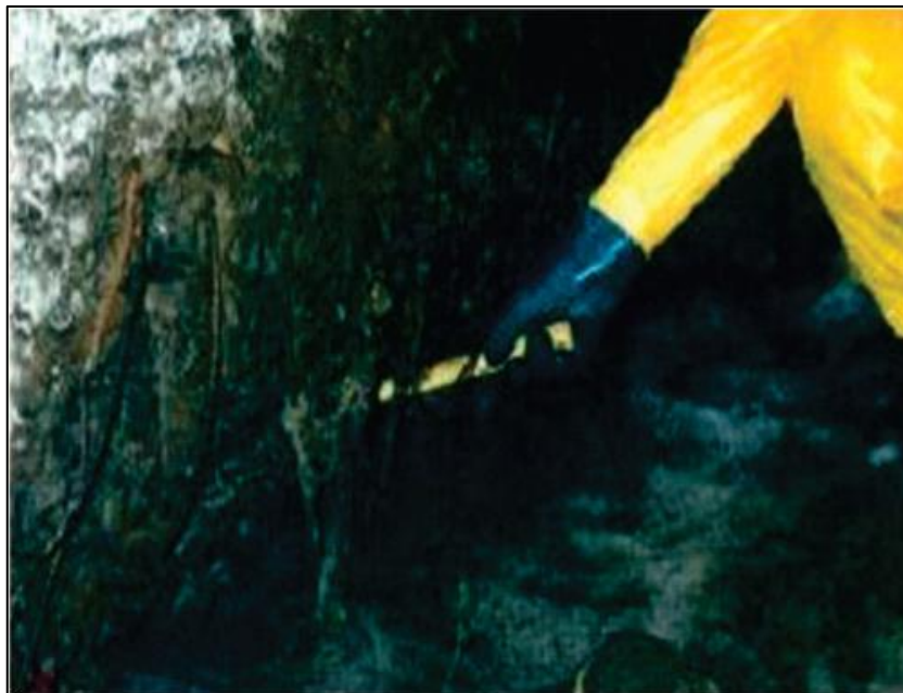
Figura 4.16: Severa degradação do concreto corroeu a base da parede da galeria. (Fonte: AGUIAR & BAPTISTA, 2011)
