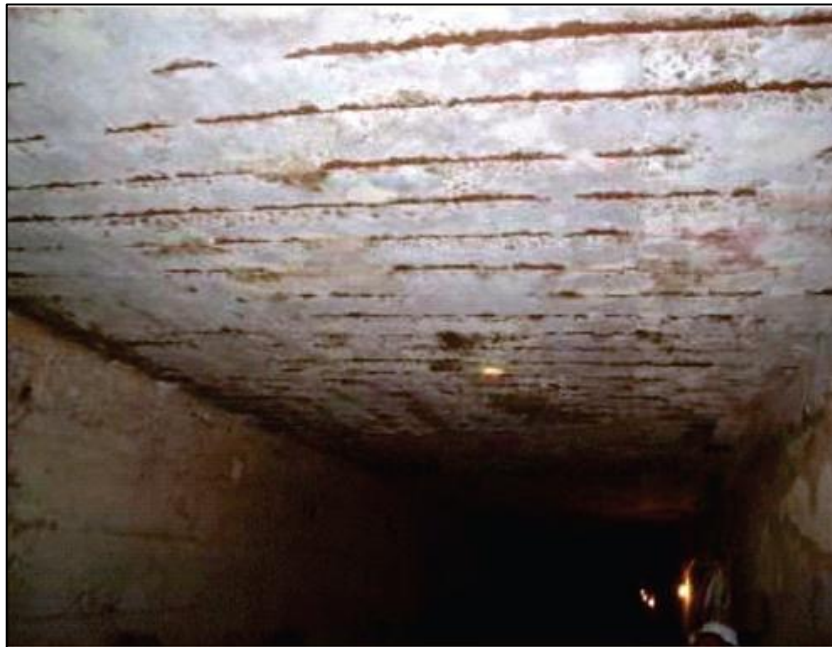
Figura 4.17: Degradação da laje da galeria, provocando exposição da armadura. (Fonte: AGUIAR & BAPTISTA, 2011)
