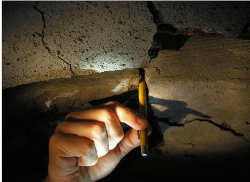
Figura 4.20: Trinca em laje superior de uma galeria. Fonte: (AGUIAR & BAPTISTA, 2009)
