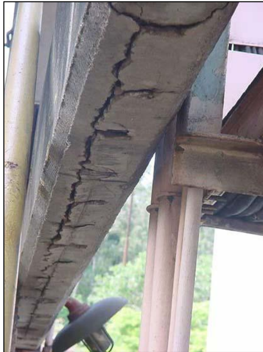
Figura 3.17: Fissuras em viga, causadas pela expansão dos óxidos gerados na corrosão. Fonte: (AGUIAR, 2006)
