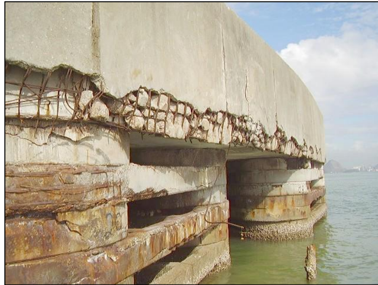
Figura 3.11: Estruturas de concreto severamente deterioradas, localizadas na linha da maré.
