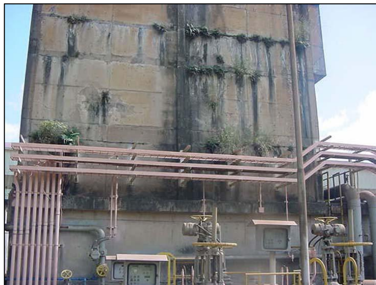
Figura 3.23: Crescimento de raízes de plantas em fendas do concreto. Fonte: (AGUIAR, 2006)
