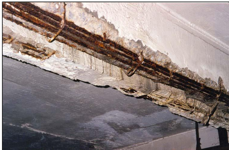
Figura 3.3: Congestionamento da armadura provocando deterioração precoce da estrutura. Fonte: (AGUIAR, 2006).
