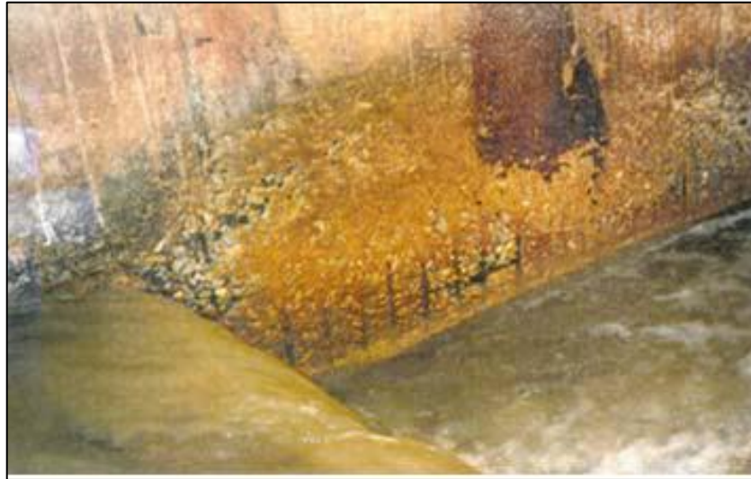
Figura 4.4: Erosão nas paredes e cavitação na região do degrau, em galeria de água pluvial. Fonte: (AGUIAR, 2006)
