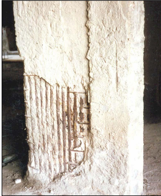
Figura 3.20: Corrosão das armaduras do pilar, em local de menor cobrimento, devido à carbonatação. Fonte: (AGUIAR, 2006)
