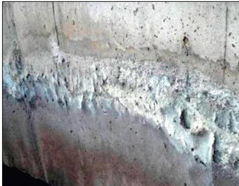
Figura 4.15: Degradação do concreto por ácido sulfúrico. (Fonte: AGUIAR & BAPTISTA, 2011)
