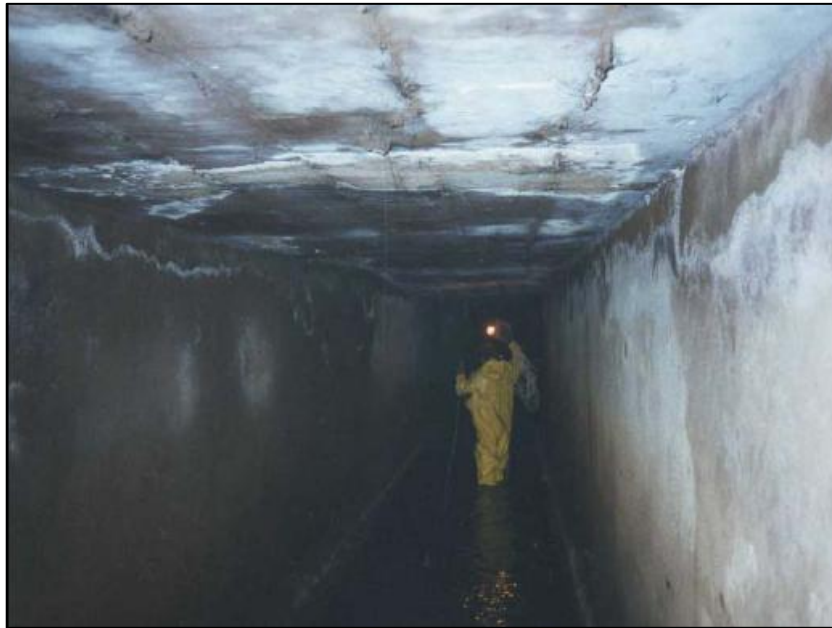
Figura 4.11: Galeria de águas pluviais contaminada por esgotos, apresentando teto manchado devido ao ataque biológico. (Fonte: AGUIAR, 2006)
