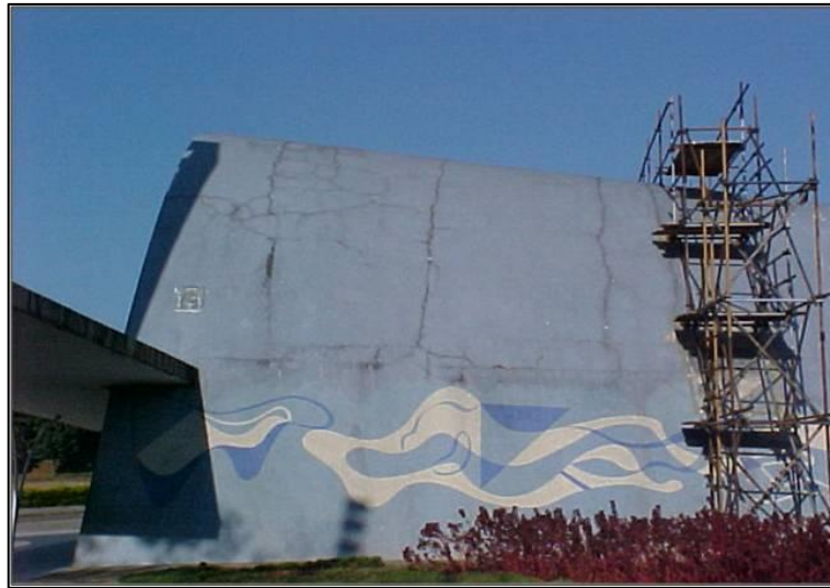
Figura 3.7: Variações térmicas provocando fissuras e trincas na cúpula da igreja. (Fonte: AGUIAR, et. al. 2006).
