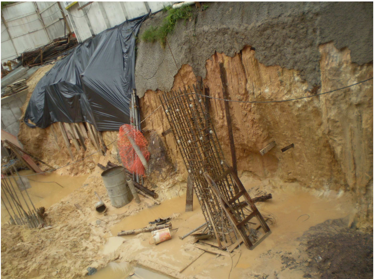
Figura 6: Surpresa Geotécnica Fonte: O autor
