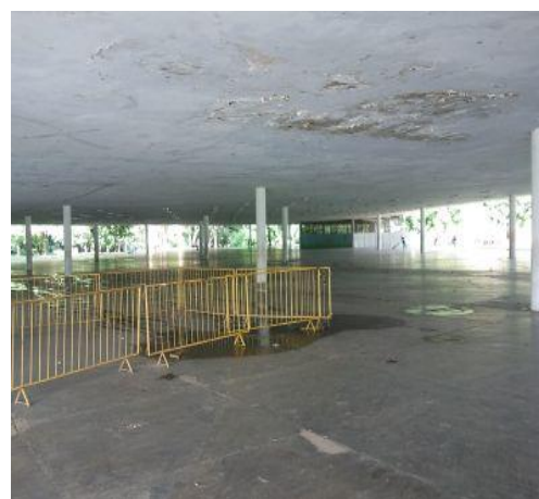
Figura 51 – Bolhas e manchas na laje
