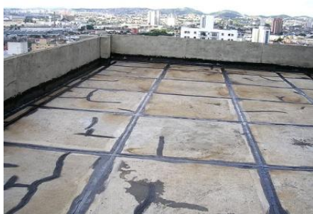
Figura 41 – Junta de dilatação Fonte: Ana Lourençon (2011)
