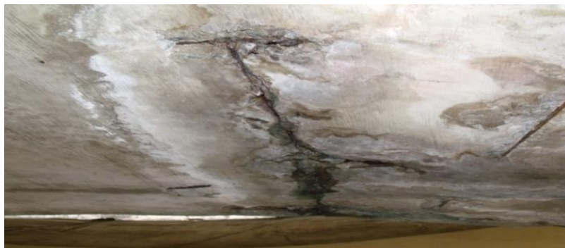
Figura 49 – Armadura exposta por falha na impermeabilização
