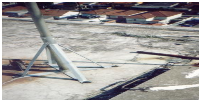
Figura 54 – Instalação inadequada de antena
