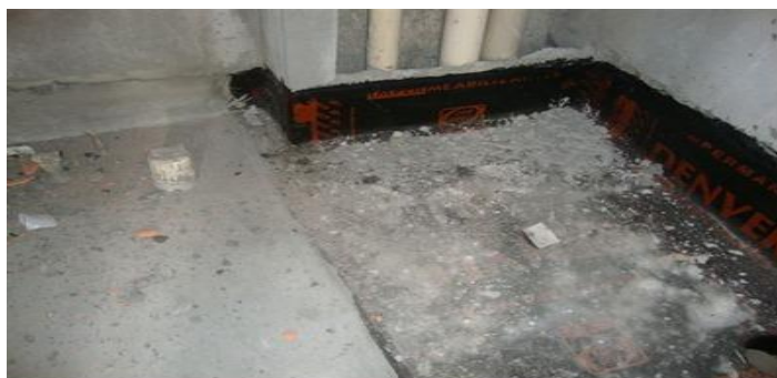
Figura 52 – Entulho sobre a laje impermeabilizada
