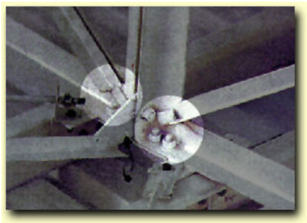
Figura 40- Amassamento em Ligação para Acesso ao Furo – Fonte: CASTRO (1999)
