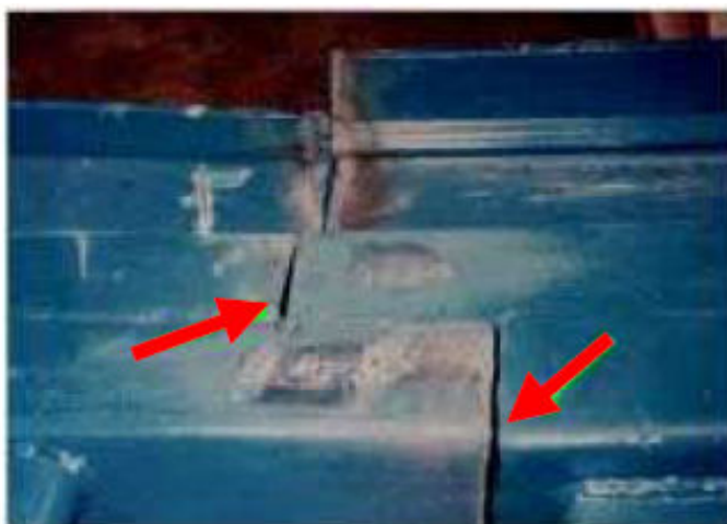
Figura 62 – Falta de usinagem nas extremidades das ligações- Fonte: CASTRO (1999)
