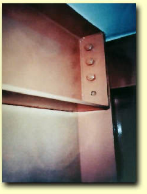
Figura 41 - Falta de Furo no Pilar – Fonte: CASTRO (1999)
