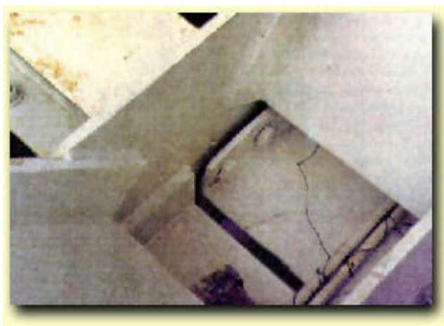
Figura 45 – Ligação instável por falta de aperto nos parafusos. – Fonte: CASTRO (1999)
