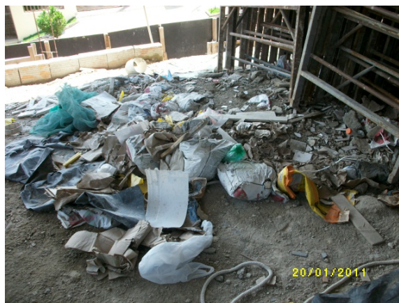
Figura 13: Acúmulo de entulho dentro do apartamento
