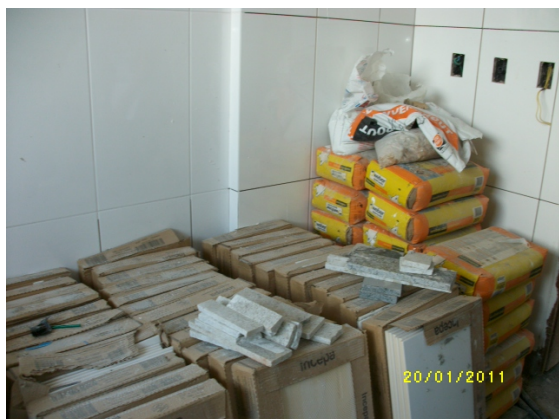
Figura 12: Excesso de material
