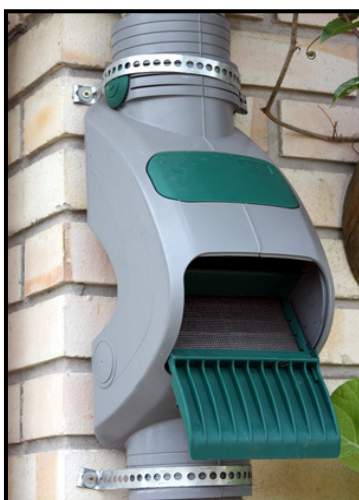
Figura 5: Filtro para descarte de sólidos instalado na tubulação de descida da calha
