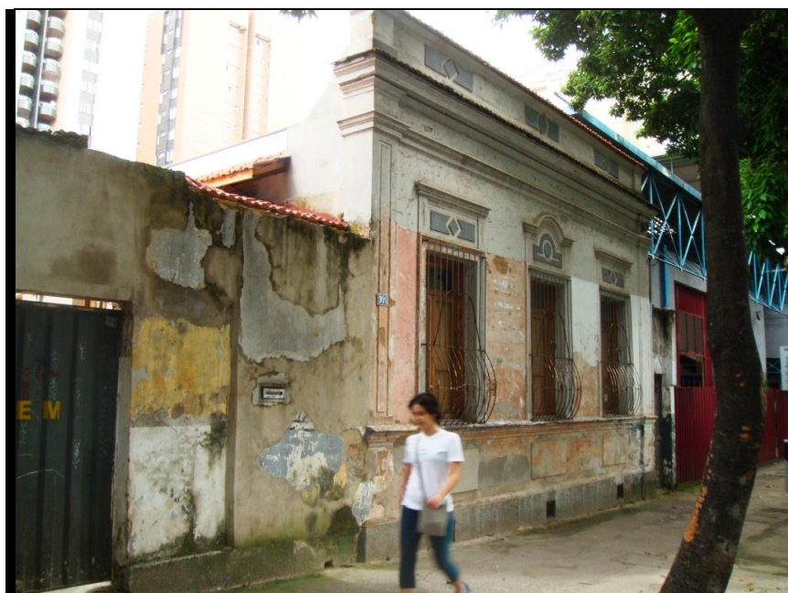
Figura 10: Vista do estado de conservação da edificação antes do início das obras de restauração. Novembro 2010.
