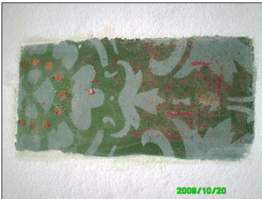
Figura 20: Vista da pintura da ante-sala antes da recuperação e que antes foi recoberta com tinta branca. Setembro 2009.
