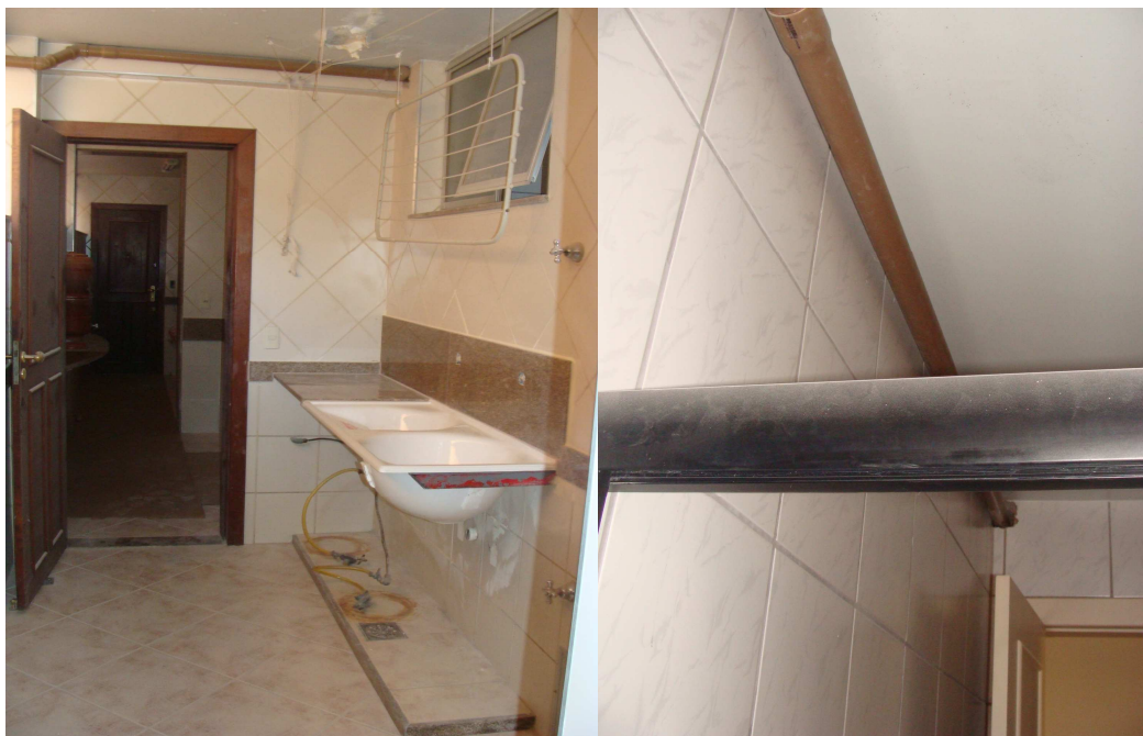
FIGURA 6- Exemplo de tubulação externa
