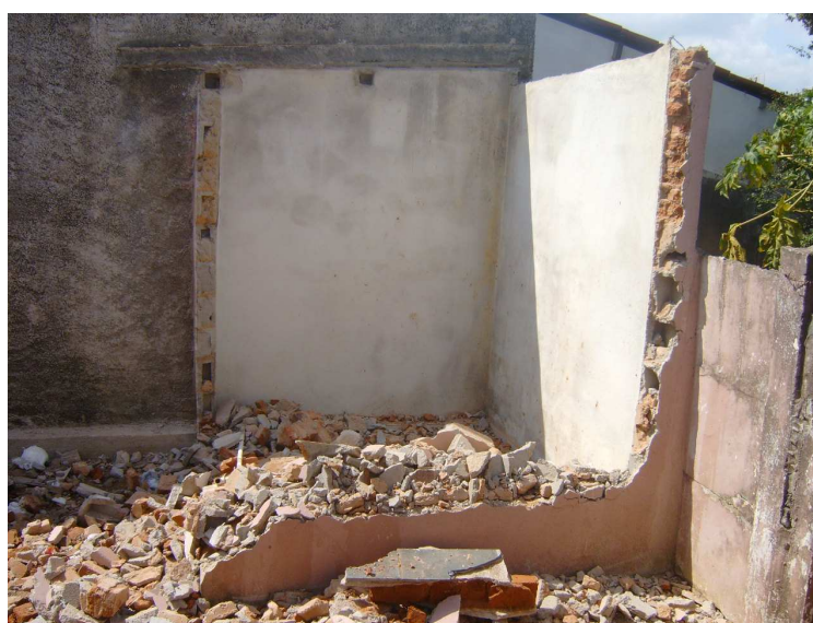
FIGURA 3- Demolição de um cômodo, onde foi aproveitado o telhado, as esquadrias e parte da alvenaria permanecerá como muro divisório.
