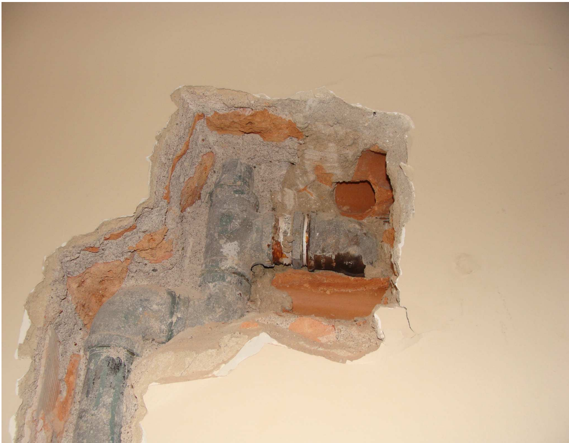
FIGURA 5- Tubulação de ferro galvanizado com corrosão
