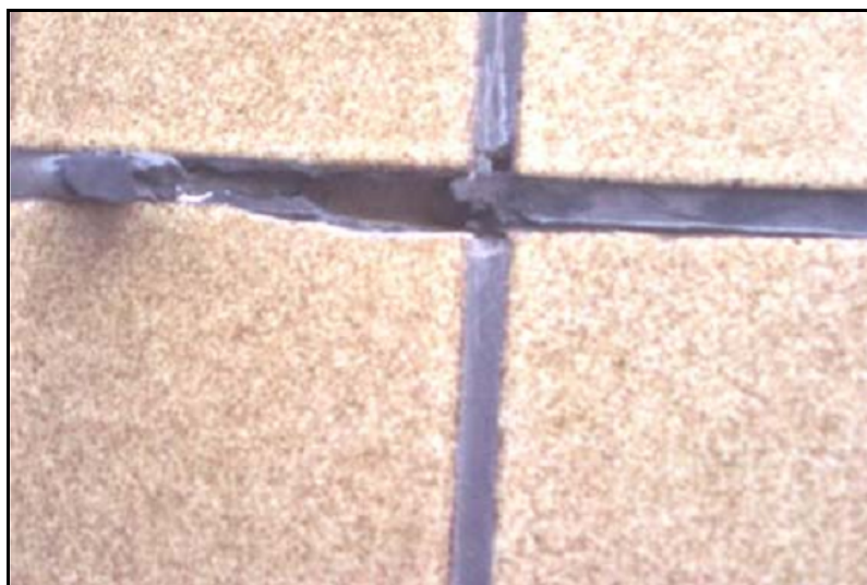
Figura 5.5: Exemplo de deterioração do rejunte
