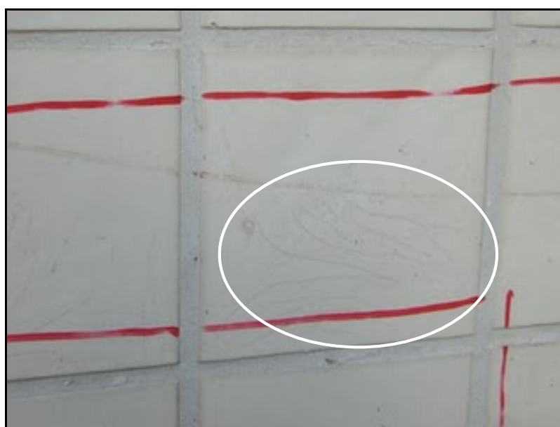
Figura 5.2: Surgência de trincas nas placas cerâmicas
