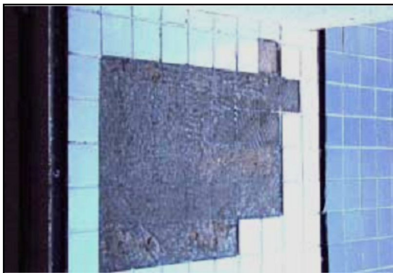
Figura 5.1: Destacamento das placas cerâmicas
