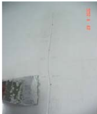
Figura 4.1 – Abertura das fissuras (Fonte: Max Junginger)
