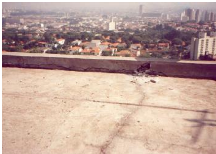
Figura 4.7 - Trinca horizontal na mureta da cobertura (Fonte: Giorgio Olivari)
