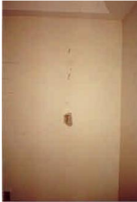
Figura 4.10 -Trinca entre alvenaria/pilar (Fonte: Giorgio Olivari)
