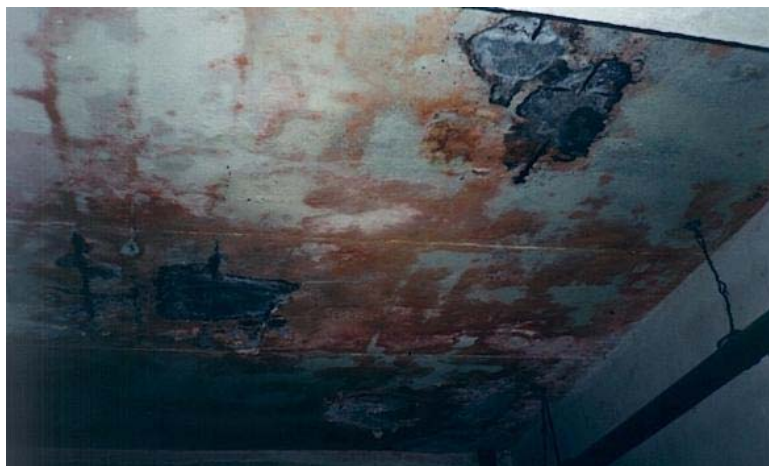
Figura 4.3 – Trinca em laje de concreto (Fonte: Jefferson Maia Lima)
