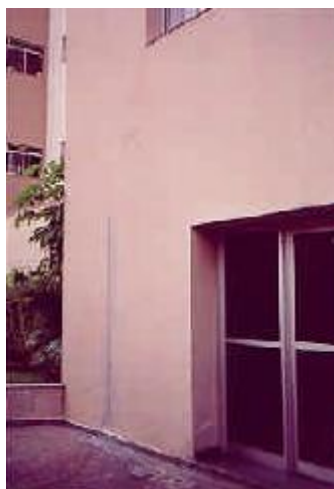
Figura 4.9 – Trinca vertical na fachada (Fonte: Giorgio Olivari)
