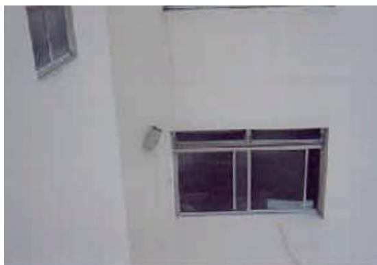
Figura 4.6 – Trinca alvenaria/viga (Fonte: Giorgio Olivari)
