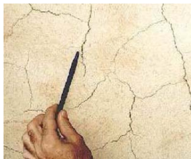
Figura 2.1 – Fissura em argamassa de revestimento
