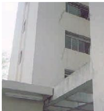
Figura 4.8 - Trincas na face inferior da janela (Fonte: Giorgio Olivari)
