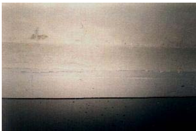
Figura 4.4 - Fissura na face inferior da viga (LIMA, J. M.)
