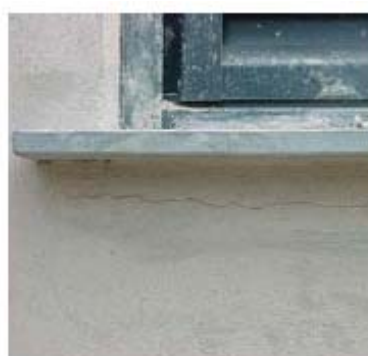
Figura 3.8 – Fissuras no entorno de janelas. (Fonte: Revista Técnica)
