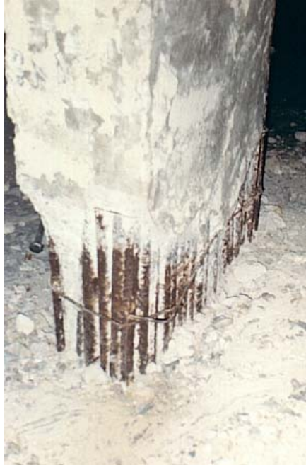
Figura. 4.5 – Fissuras em pilares (Fonte: Jefferson Maia Lima)
