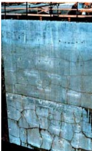
Figura 3.2 - Fissuras causadas por movimentações térmicas
