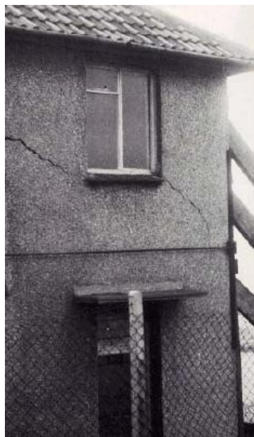
Figura 3.50 – Fissuras por recalque da fundação (Fonte: ELDRIDGE)
