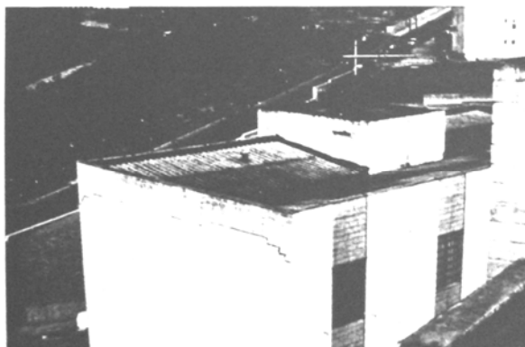
Figura 3.16 – Trincas inclinadas no topo da parede (em ambas as extremidades) e o destacamento da platibanda causados por movimentações térmicas. (Fonte: THOMAZ)
