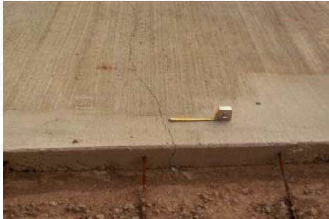
Figura 3.61 – Trincas causadas por retração de secagem
