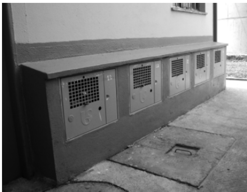
Figura 4.1.2b – Grupo de medidores no pavimento térreo – Adaptado de SANEAS (março de 2006)
