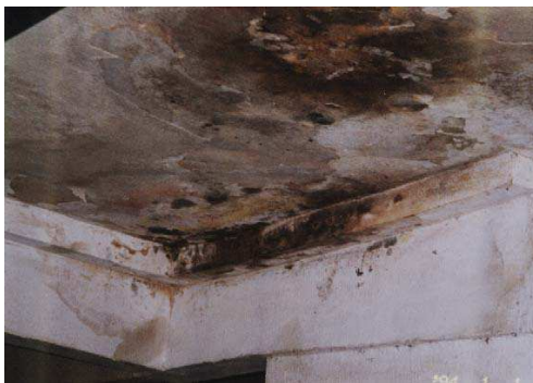
Fig. 13 “Viga com infiltração”.
