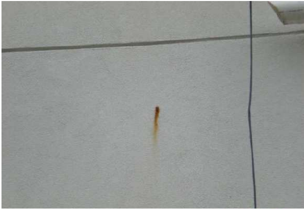
Fig. 11 “ Fachada dos fundos com pontos de ferrugem aflorando da pintura”.
