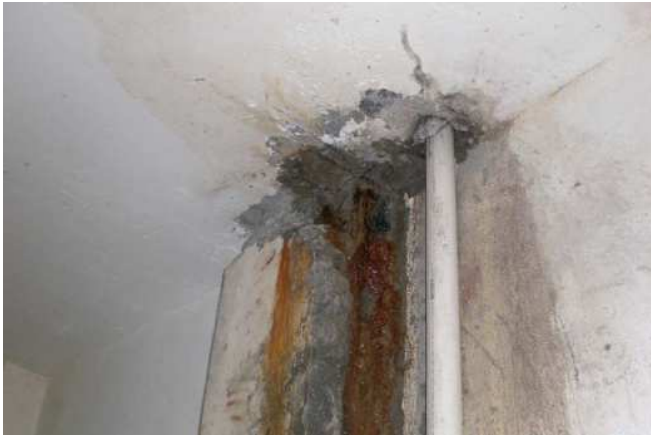
Fig. 12 “Pilar com ponto de ferrugem devido à umidade”.
