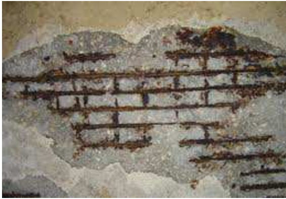
Fig. 4 “Estrutura de concreto exposta a corrosão”.
