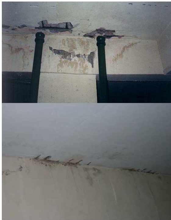
Fig. 14 “Lajes com pontos de infiltração”.
