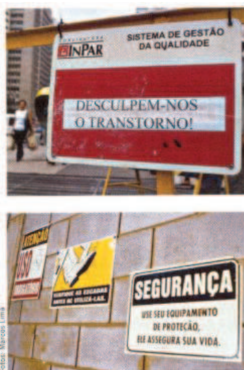
Figura 04 – Exemplos de sinalização em canteiros de obra
