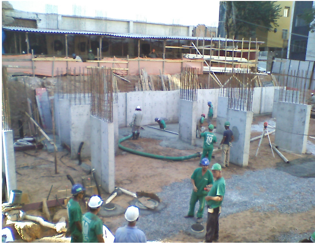
Figura 1 – Foto da concretagem do subsolo, antes da primeira laje (arquivo do autor, 2012).
