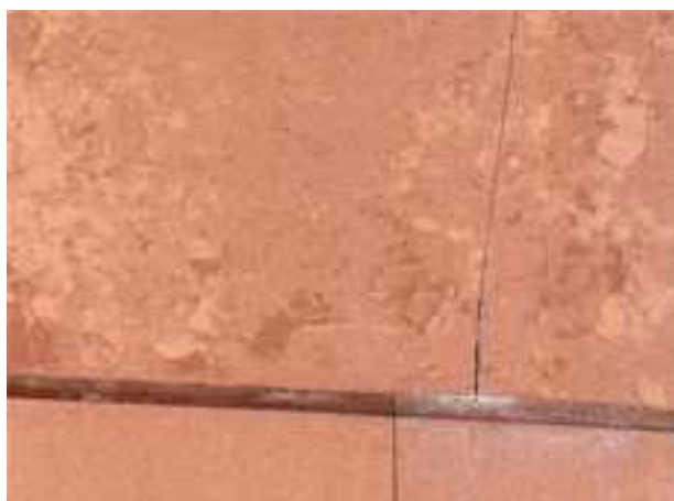
Figura 7: Migração de fissura da base para revestimento
