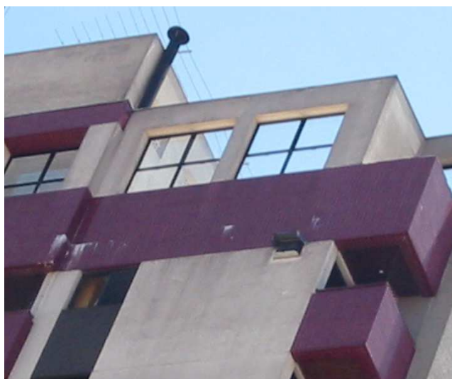
Figura 8: Formação de eflorescência em fachadas revestidas
