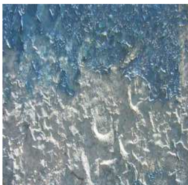
Figura 28: Eflorescência em texturas roladas
