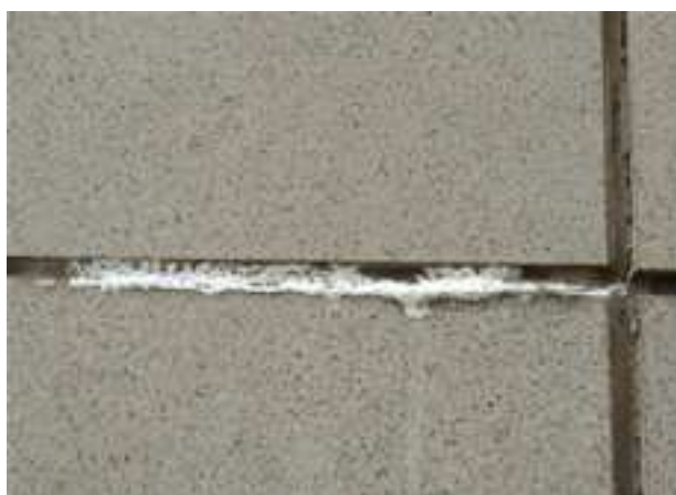
Figura 10: Deterioração do rejunte para ocorrência de eflorescência FONTE: Patologias cerâmicas, Giselle Cichinelli, 2012, disponível em http://www.revistatechne.com.br/engenharia-civil/116/artigo35346-3.asp
