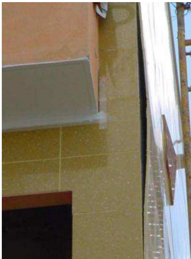
Figura 5: Deslocamento com empolamento grave
