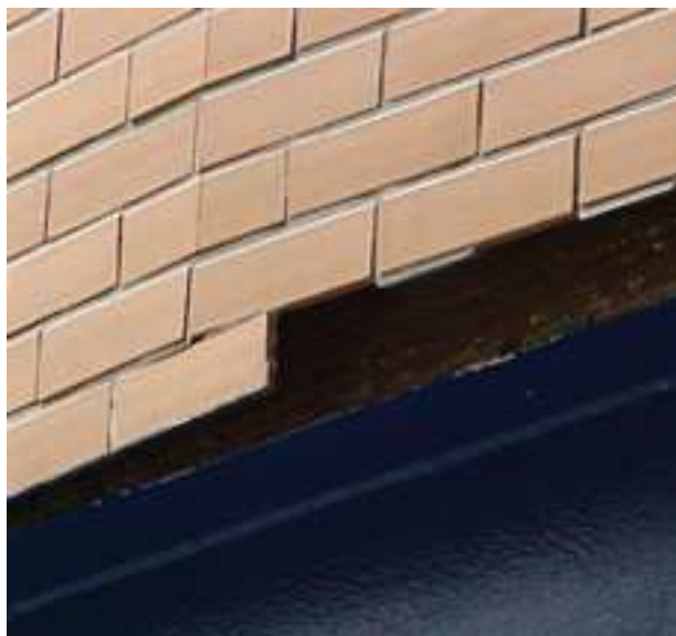
Figura 6: Deslocamento em placas
